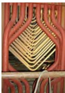
Obr. 13 Kotlové trubky, průřez
