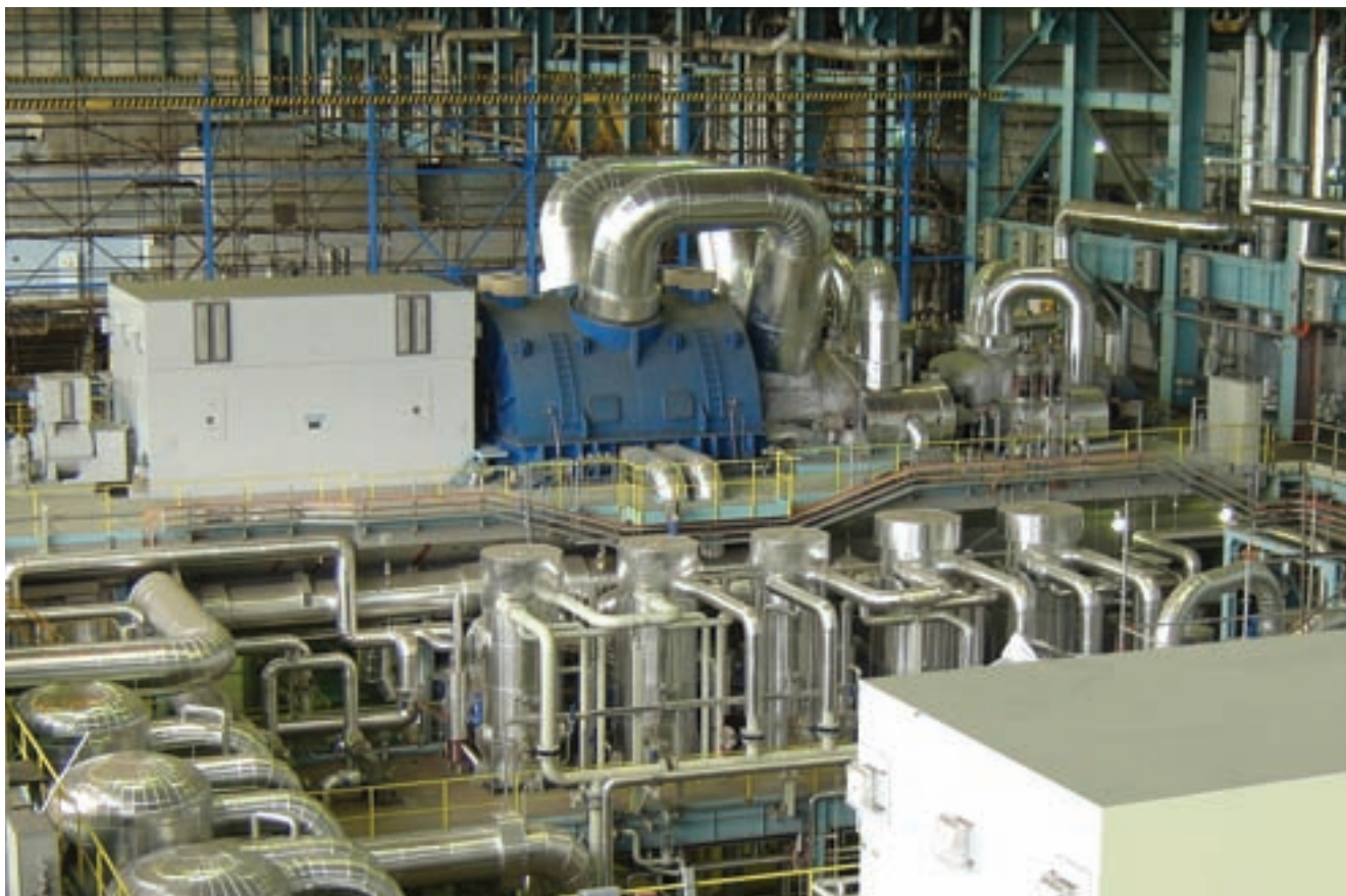
Pohled do strojovny bloku 23
