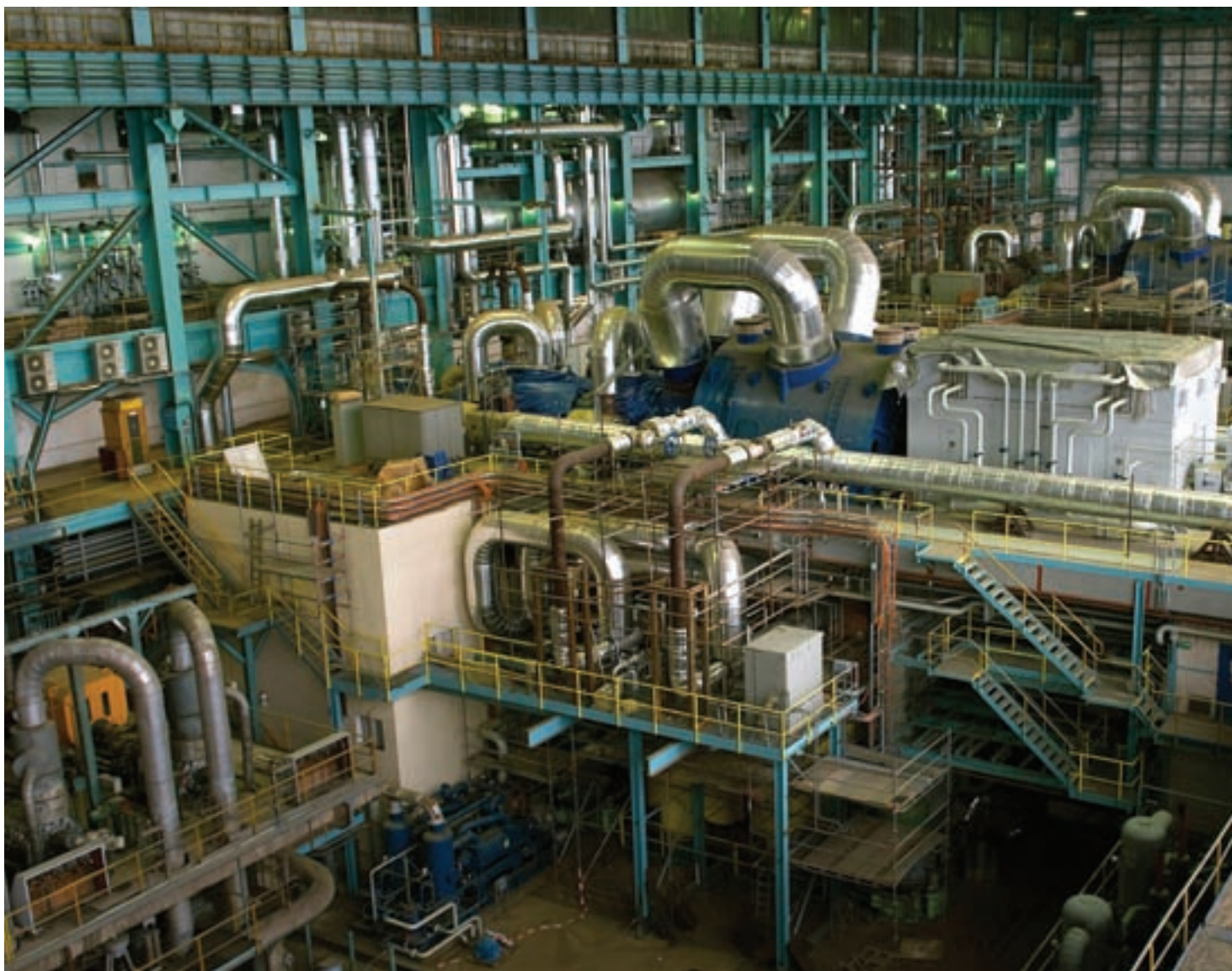
Strojovna – rekonstruované turbogenerátory bloků 23 a 24
