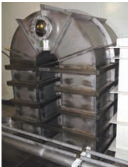
Nově vytvořený sifon vzduchotechnického kanálu
