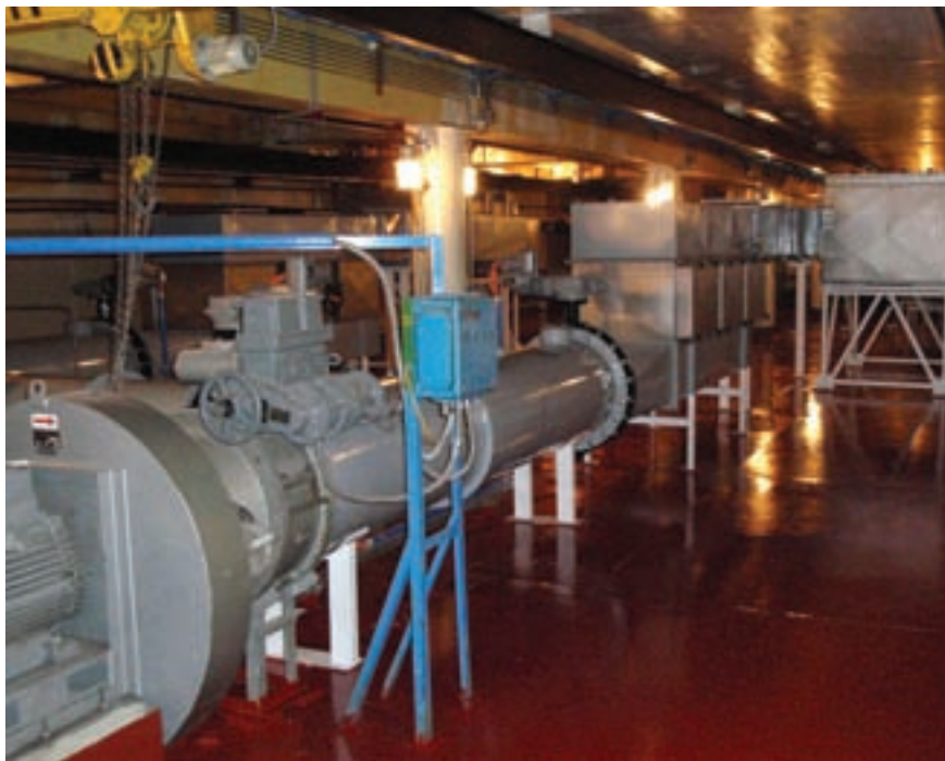
Pohled od ventilátorů na část aerosolové a uhebné filtrace systému TL12
