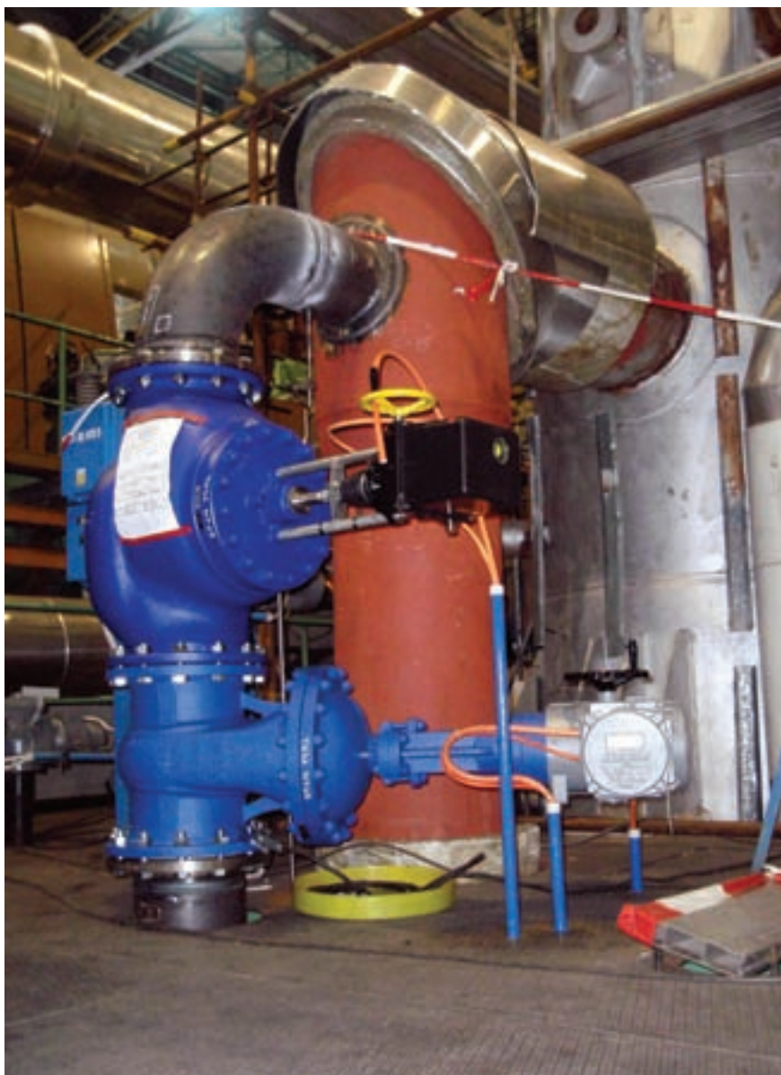
Sestava regulačního a uzavíracího ventilu pro jednu z turbín na 4. bloku pro NTO5 po montáži, zatím bez izolací
