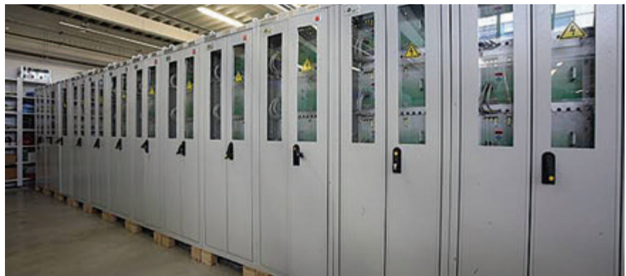
Skříňe RRCS ve zkušebně firmy ZAT
