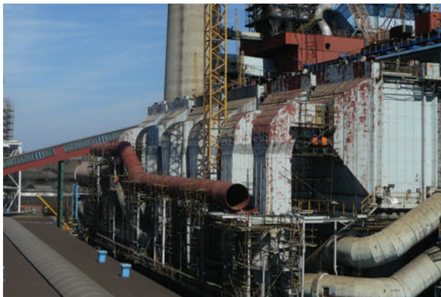
Na snímku pohled na elektrostatické odlučovače prachu
