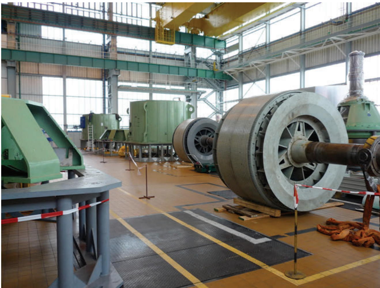
Obr. 1 – Statory a rotory největších motorů na Temelíně. Motory pohánějí čerpadla chladící vody – tzv. terciálního okruhu. Váží 63 tun. Každé čerpadlo dodává do kondenzátorů turbín 17 m 3 vody za vteřinu. Na jednom bloku jsou čerpadla dvě
