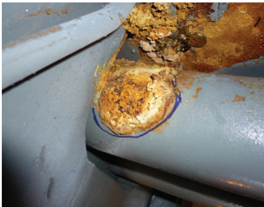
Obr. 4 – Detail poškození. Místo bylo následně opraveno a zkontrolováno kapilární zkouškou
