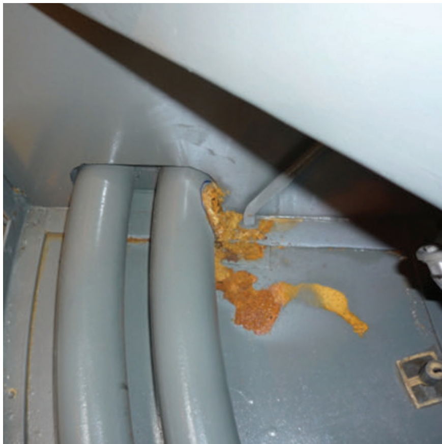
Obr. 3 – Při vizuální kontrole zjištěno prosakování vody přes zeslabené potrubí chladicí vody
