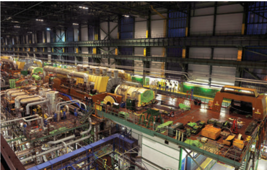
Pohled do haly strojovny
