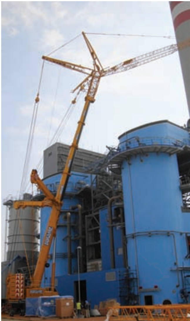
FGD Slovnaft - pohled na absorbéry s recirkulačním potrubím
