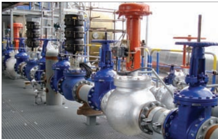
FGD Slovnaft - potrubí páry
