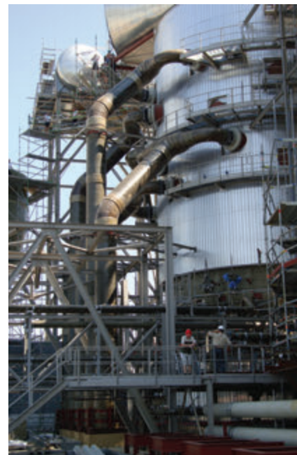
Potrubní systém odsíření elektrárny Tušimice II
