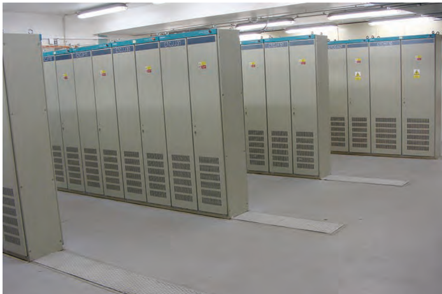
Ukázka aplikace rozvaděče řídicího systému SPPA – T3000
