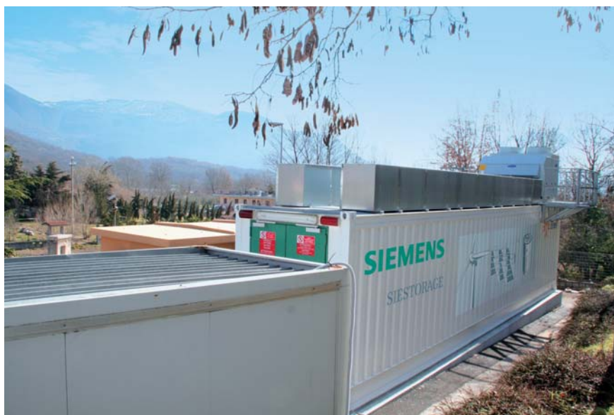
Obr. 4 – Pilotní projekt systému Siestorage pro Enel
