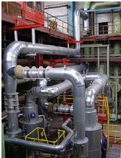
Potrubné prepojenia medzi novými kotlami K4, K5 a technológiou strojovne, včítane turbíny – ilustračná foto
