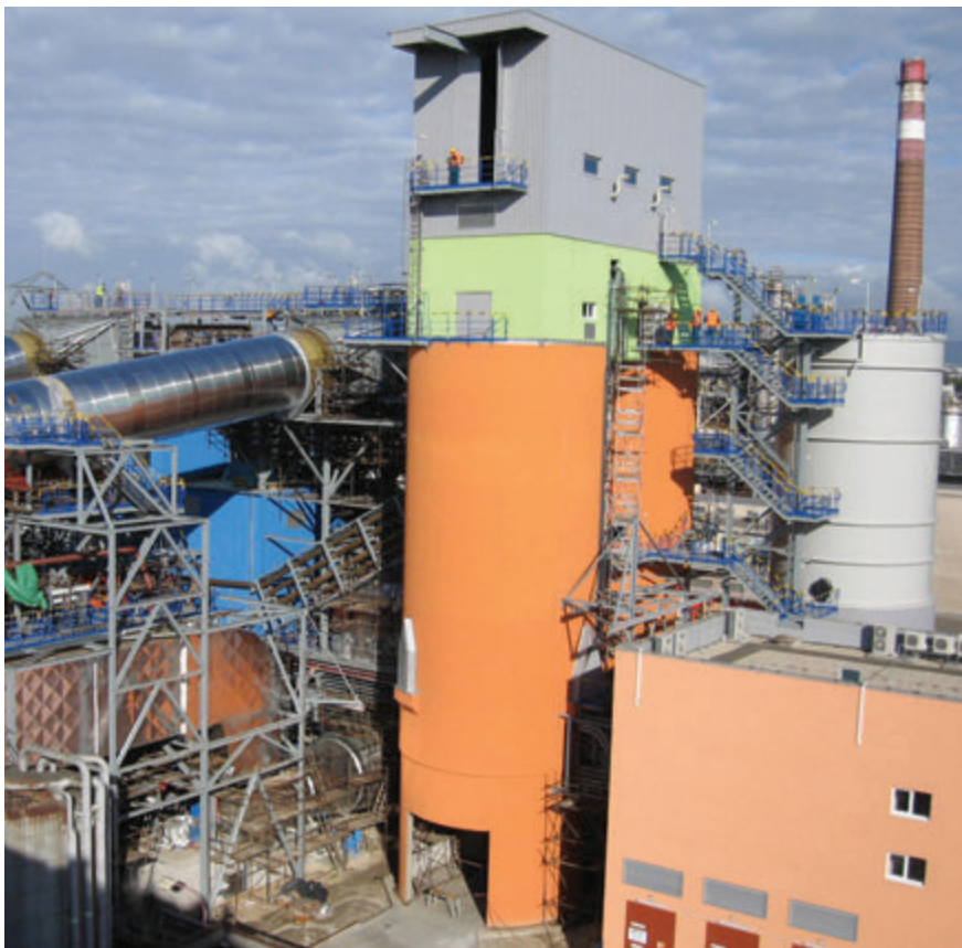
Odsírovacia jednotka spalín pripravená na garančnú skúšku
