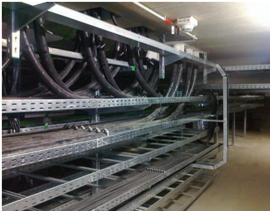
Káblový priestor pod rozvodňou nového turbogenerátora TG5
