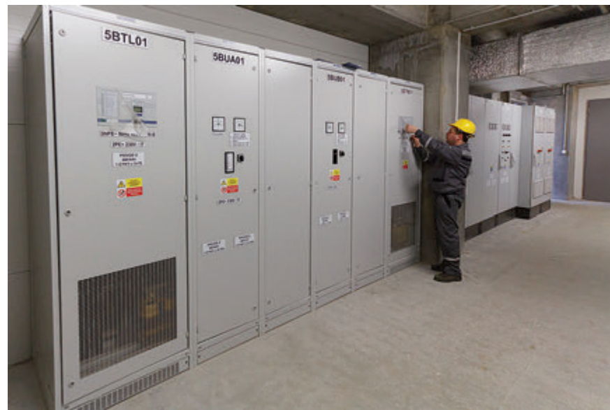
Rozvádzače 230VDC a frekvenčné meniče v novej rozvodni TG5
