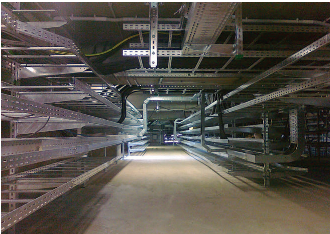
Káblový priestor pod rozvodňou nového turbogenerátora TG5
