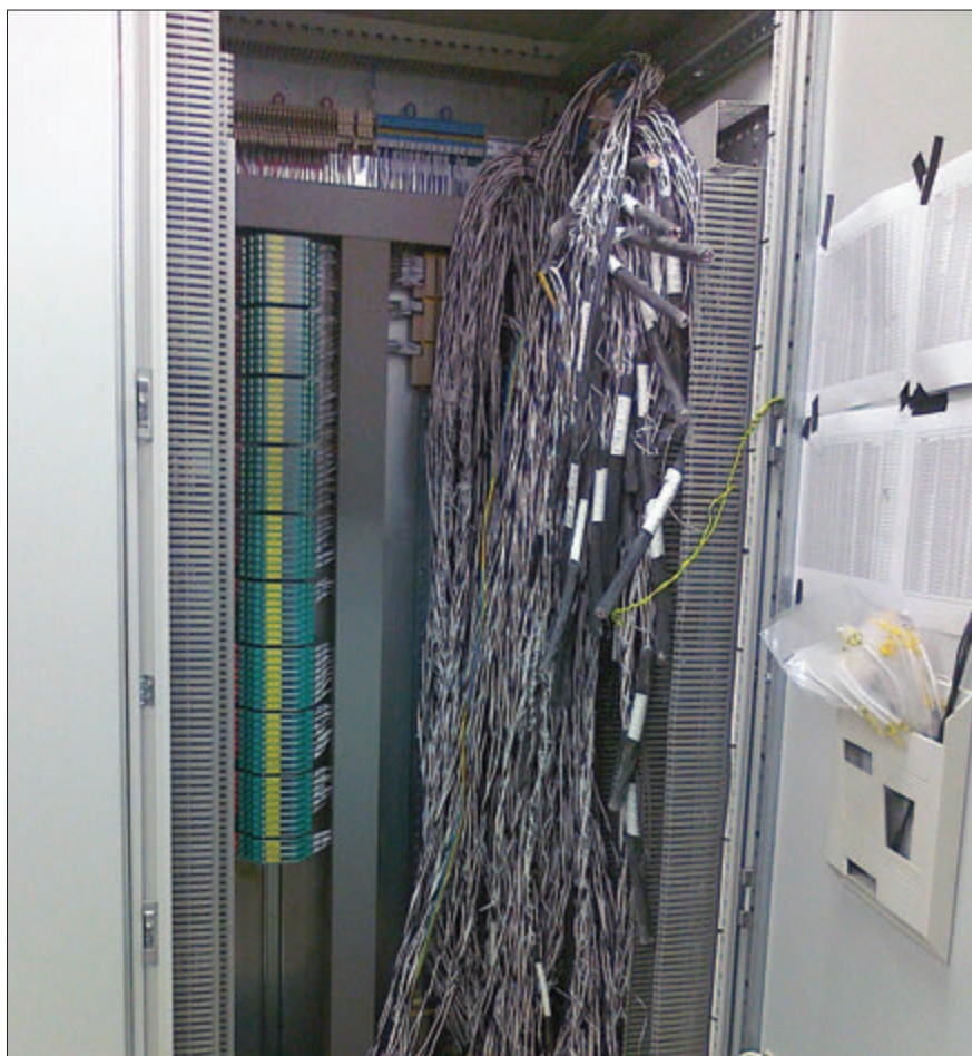
Zapájanie signálov z prevádzky. Obmedzené priestory existujúcich rozvodní vyžadovali zvýšenú hustotu montáže
