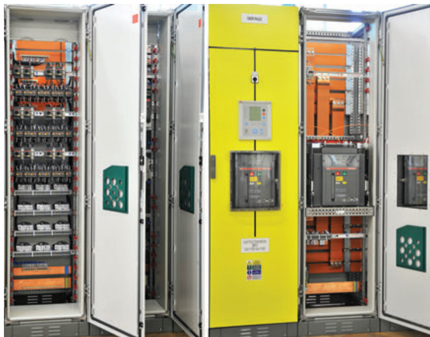
NN rozvádzače pripravené na FAT
