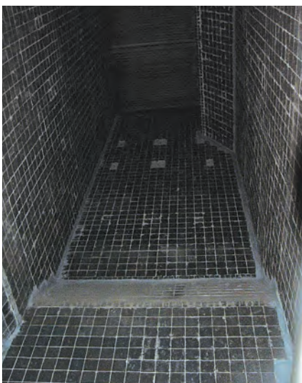
Vzdávky ve spalovací komoře parního kotle
