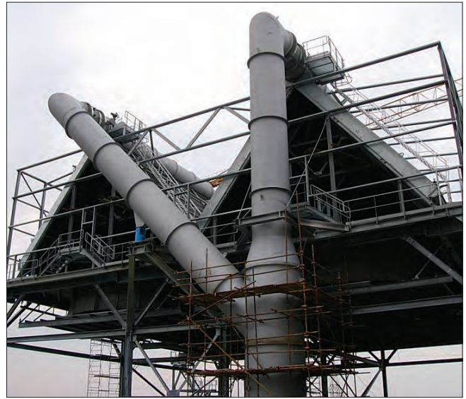
Aerokondenzátor bez protihlukového krytu a izolací
