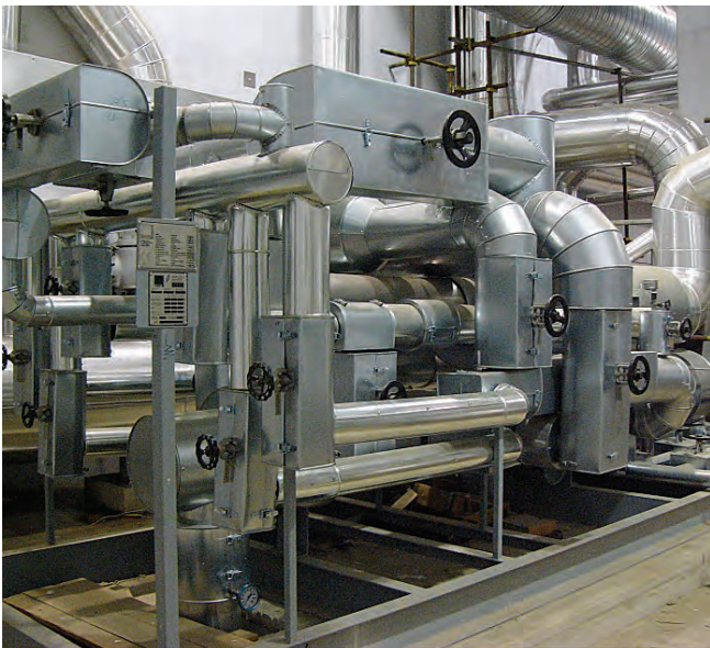
Vakuovací jednotka aerokondenzátoru
