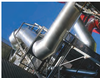
Kouřovody čištění spalin
