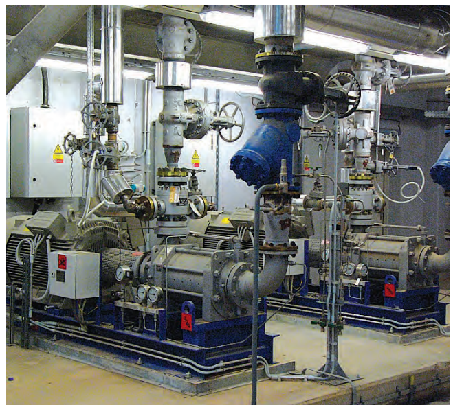
Napájecí čerpadla parních kotlů
