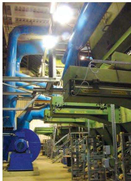
Pohony podávacího stolu spalovacího roštu
