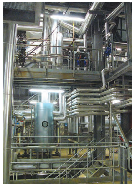
Potrubní rozvody v kotelně
