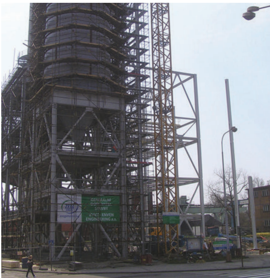
Pohled na zařízení odsíření (duben 2013)
