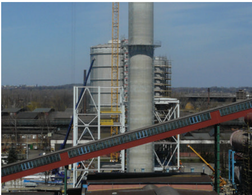
Pohled na umístění technologie odsíření
