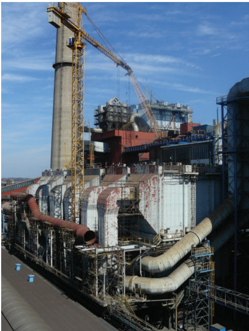
Elektrostatické odlučovače kotlů
