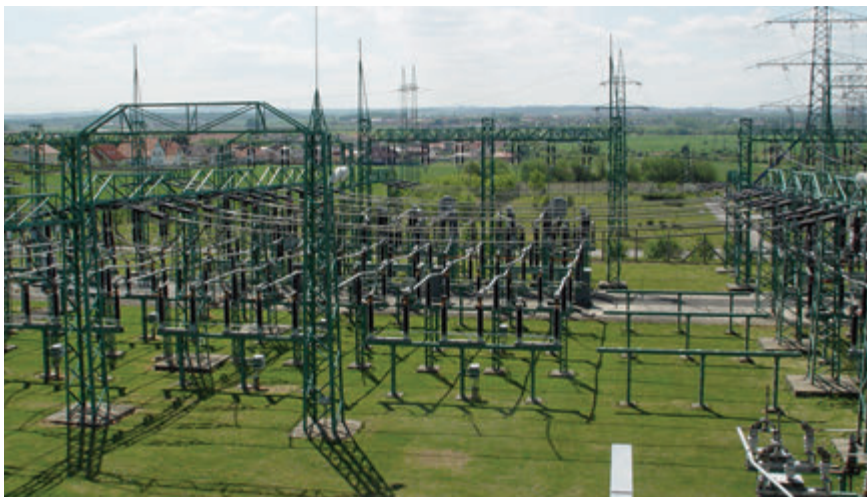
Pohled na transformovnu Chodov - ilustrační foto
