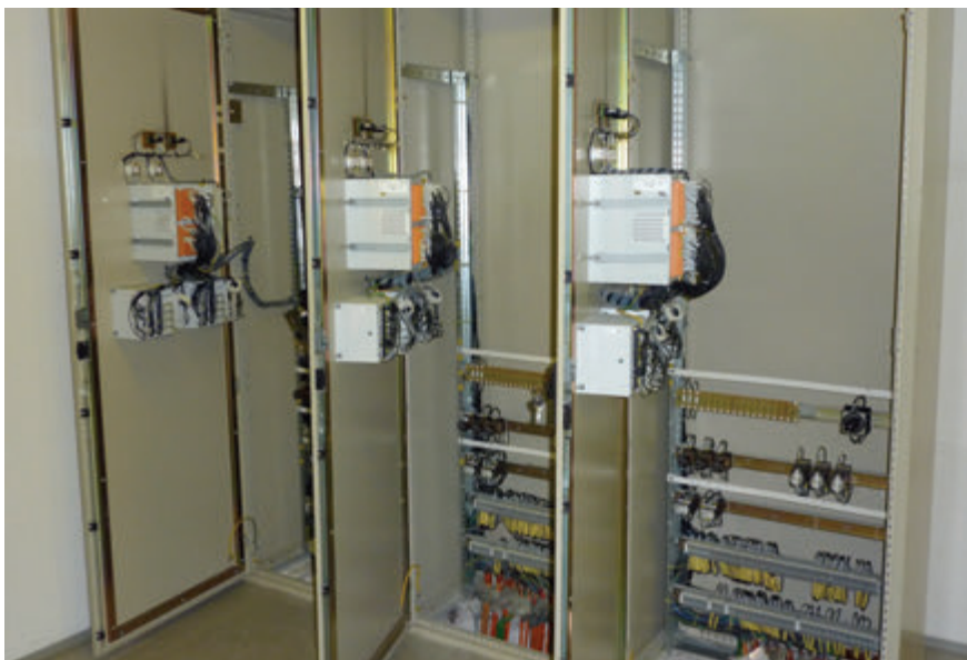
Obr. 4 – pohled do rozvaděčové skříně s novými ochranami
