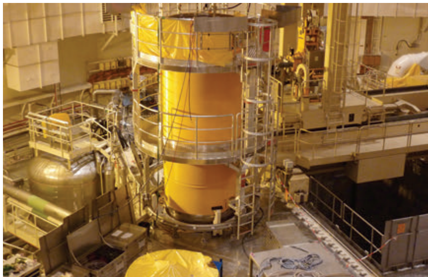
Obr. 6 – pohled na kontejner CASTOR na vyhořelé jaderné palivo na servisním místě na reaktorovém sále
