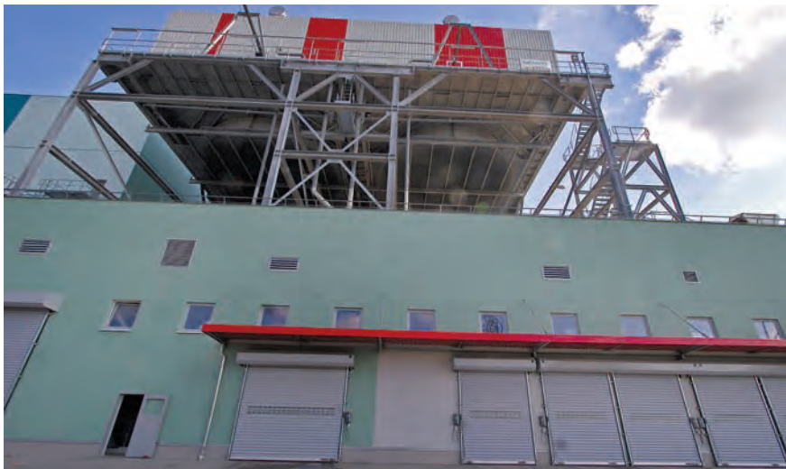
Hala dotřídřovací linky a turbosoustrojů s konstrukcí vzduchového kondenzátoru na střeše
