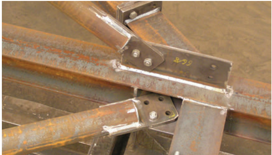
Detail šroubového styku dokazující nutnost dílenských sestav
