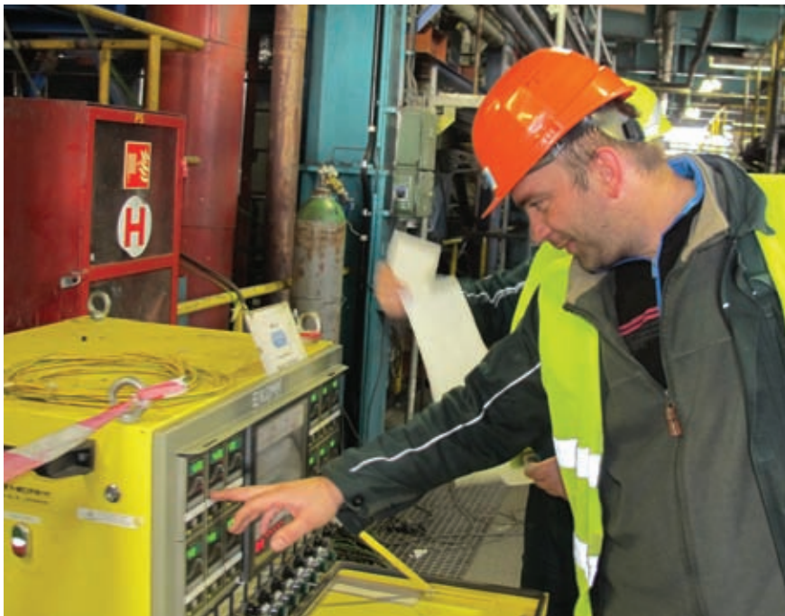
V rámci zakázky ve Strakonících byl použit žíhací stroj (na snímku), který byl poprvé aplikován v rámci rekonstrukce parovodů v elektrárně Chvalovice
