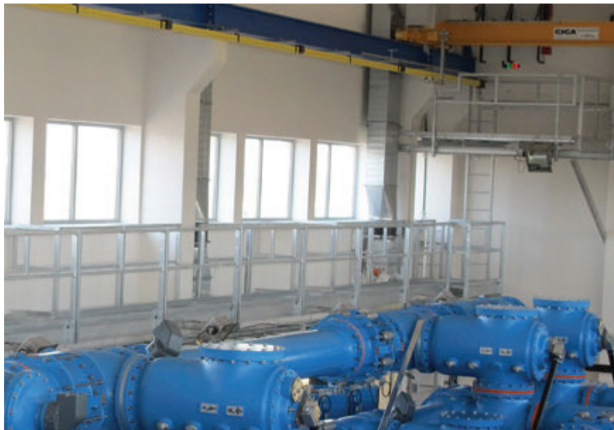
Jeřáb v budově se zapouzdřenou rozvodnou
