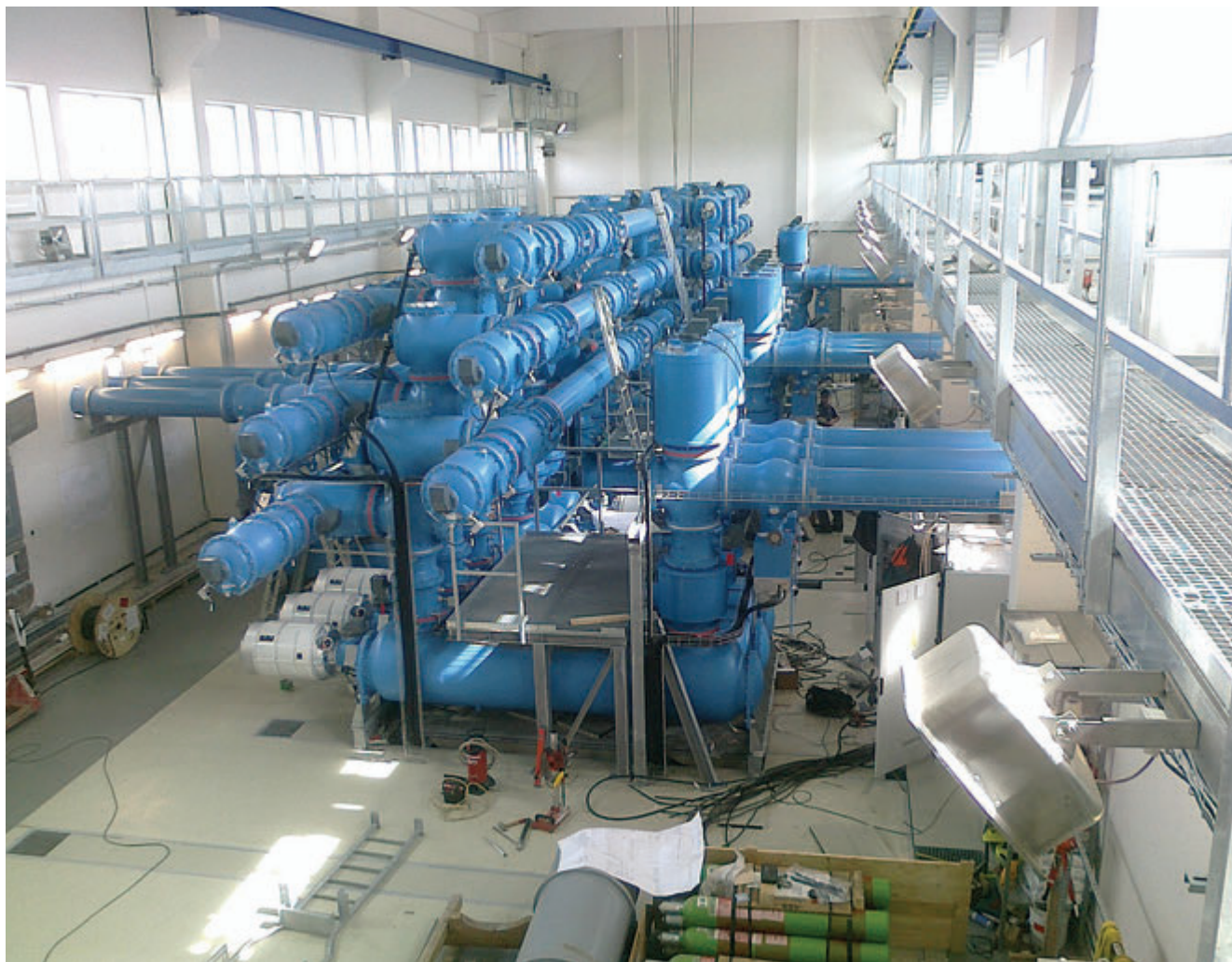
Pohled na zapouzdřenou rozvodnu
