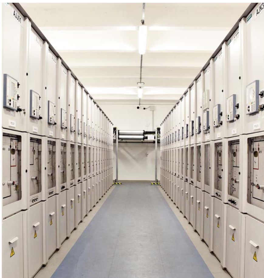
Praha Pankrác, transformovna 110/22 kV (realizace 2007 až 2010). Cofely (Fabricom) pro svého zákazníka PRE distribuce, a. s. vystavělo novou zapouzďenou, plynem izolovanou rozvodnu 110 kV s použitím dvou systémů přípojníc, osazením dvou transformátorů a čtyř vývodových polí 110 kV
