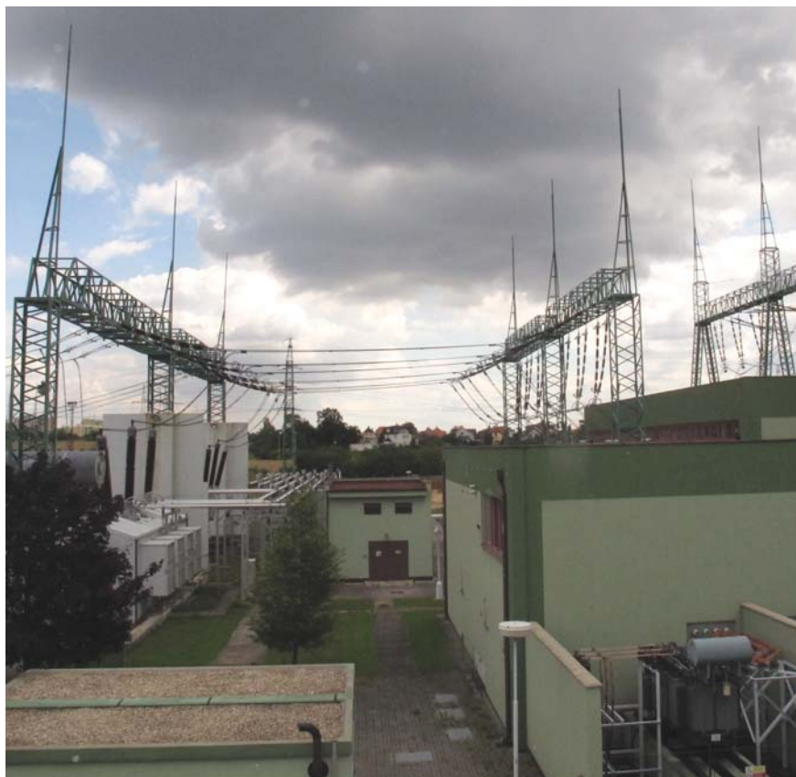
Pohled na transformovnu Chodov - ilustrační foto
