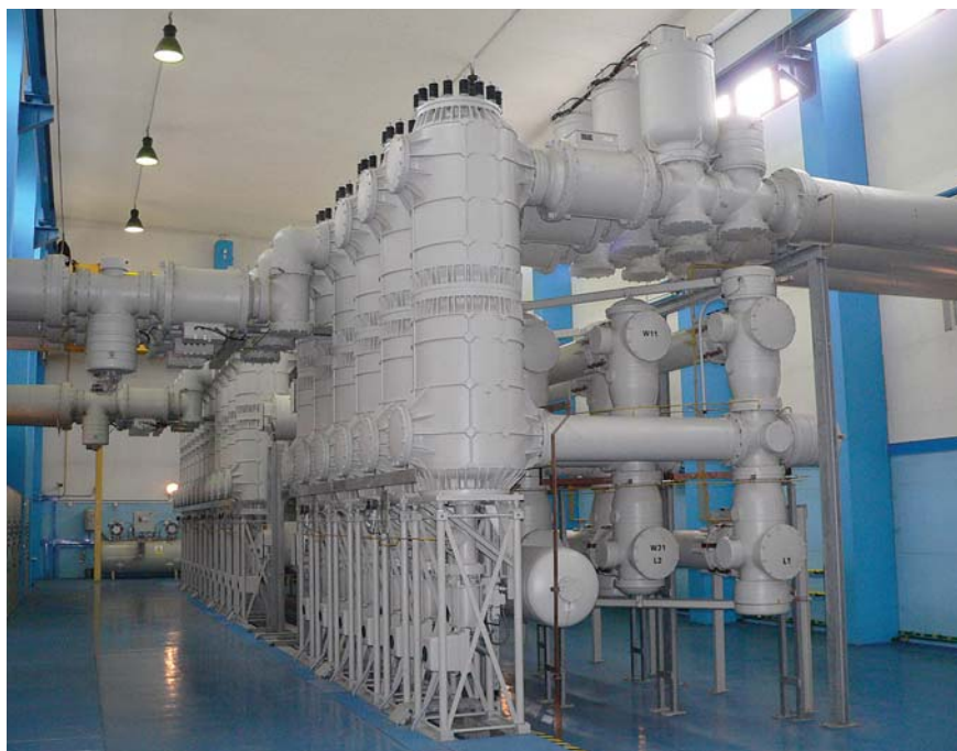
Obr. 2 – Pohled na vnitřek rozvodny 420 kV
