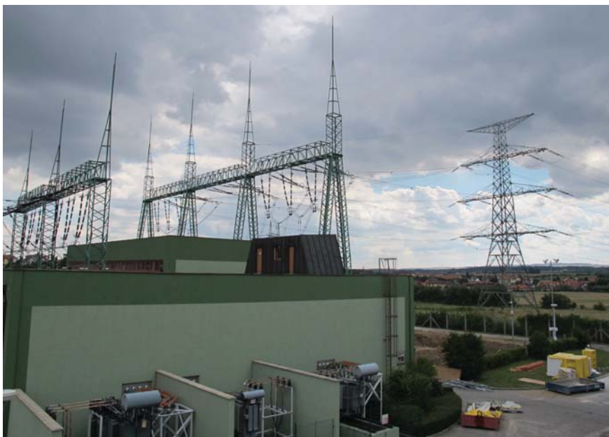
Pohled na transformovnu Chodov
