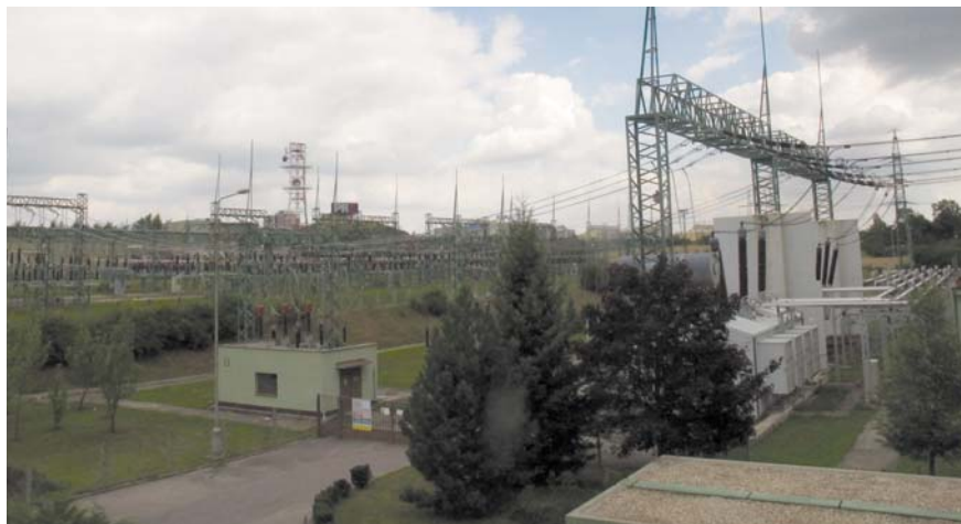
Část vyvedení výkonu z transformovny k distributorovi PRE
