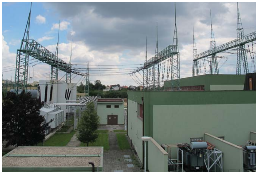
Pohled na transformovnu Chodov
