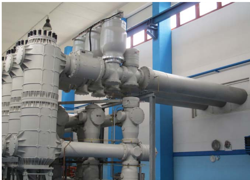
Zapouzdřená rozvodna bude rozšířena o jedno pole
