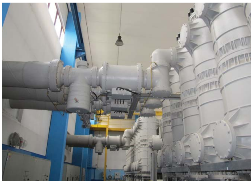
Pohled na část zapouzdřené rozvodny v Chodově
