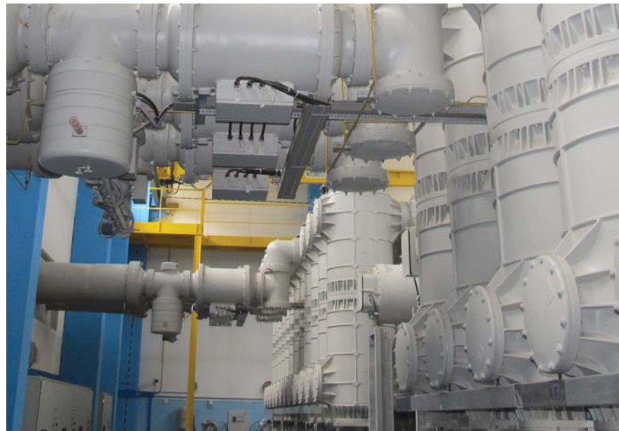
Pohled na část zapouzdřené rozvodny v Chodově - ilustrační foto
