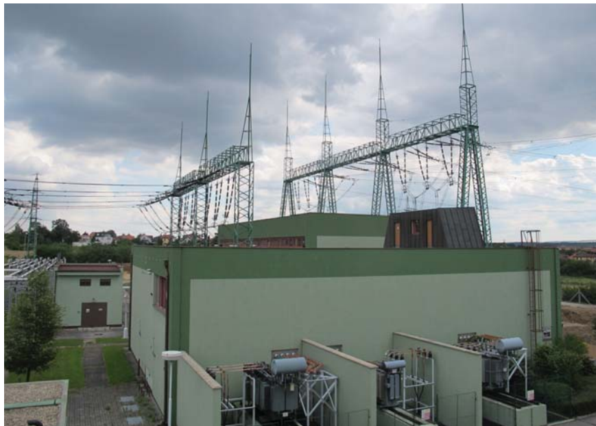
Pohled na část transformovny 400 kV v pražském Chodově
