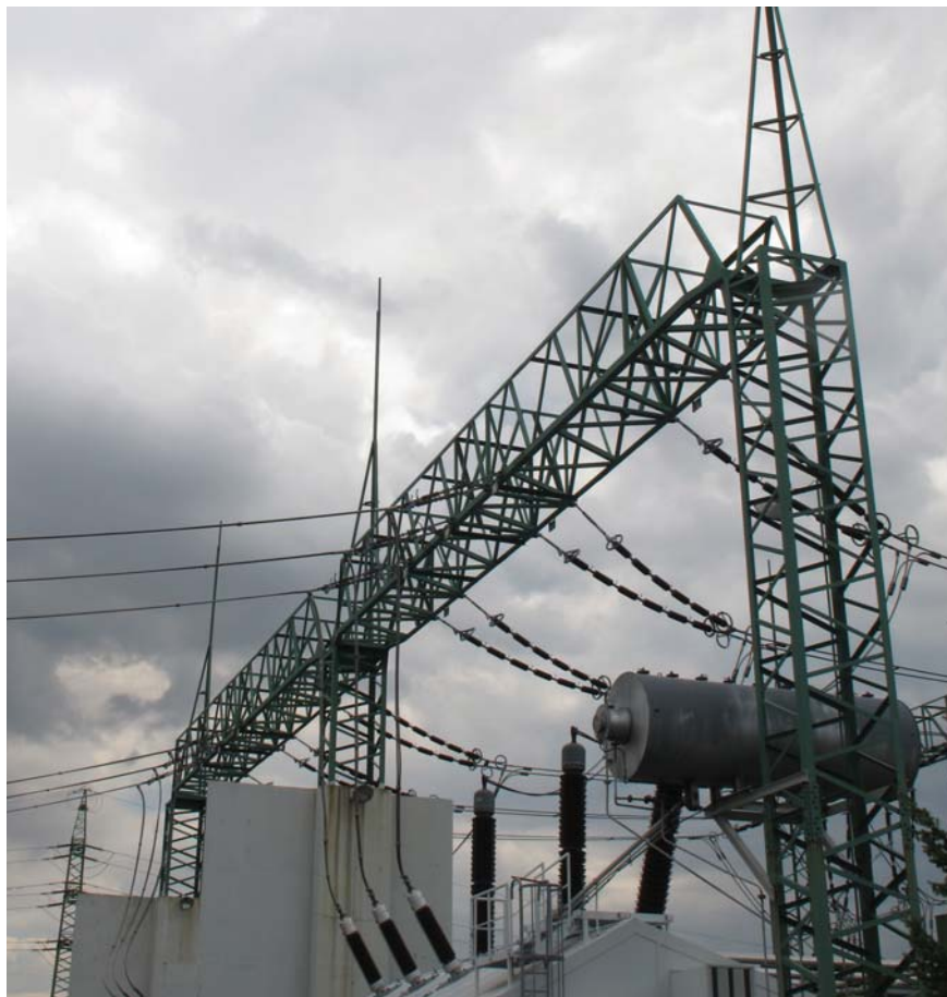
Detail na část rozvodů transformovny Chodov - ilustrační foto
