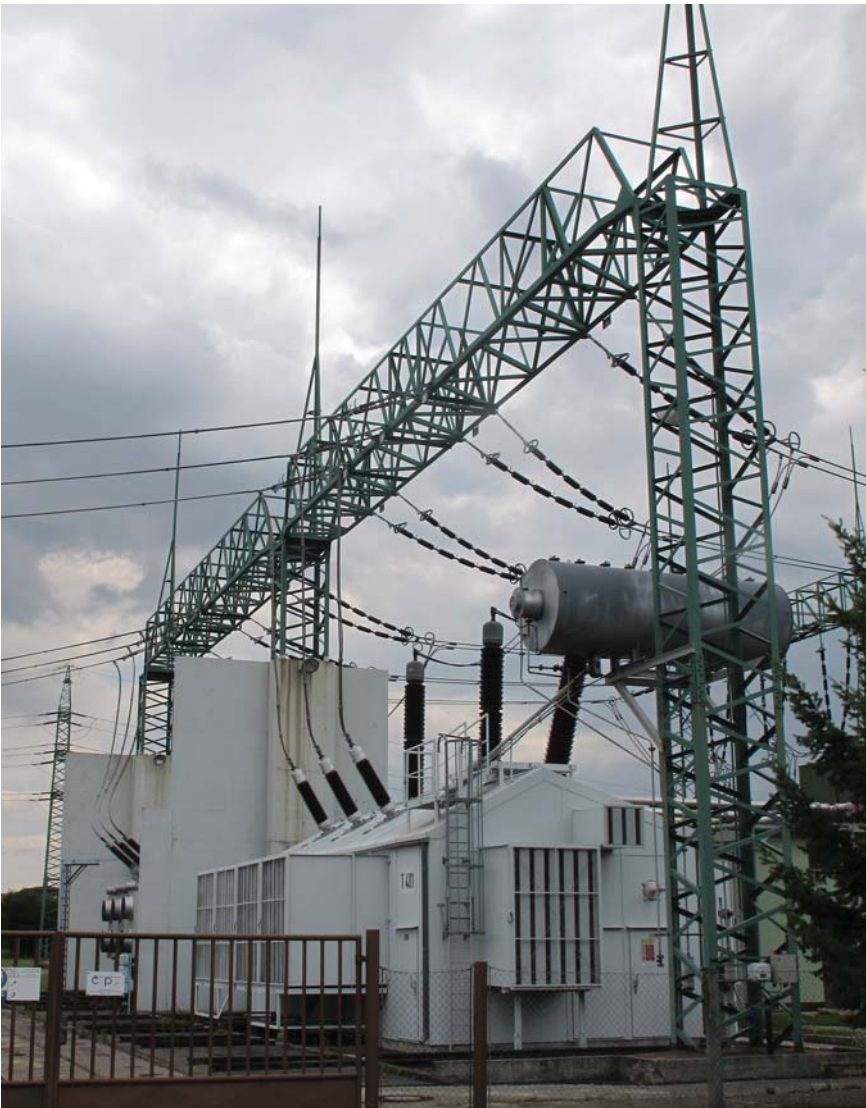
Stanoviště transformátorů v transformovně Chodov
