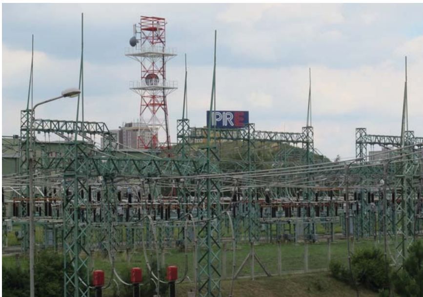
Z rozvodny Chodov se výkon vyvádí do distribuční soustavy
