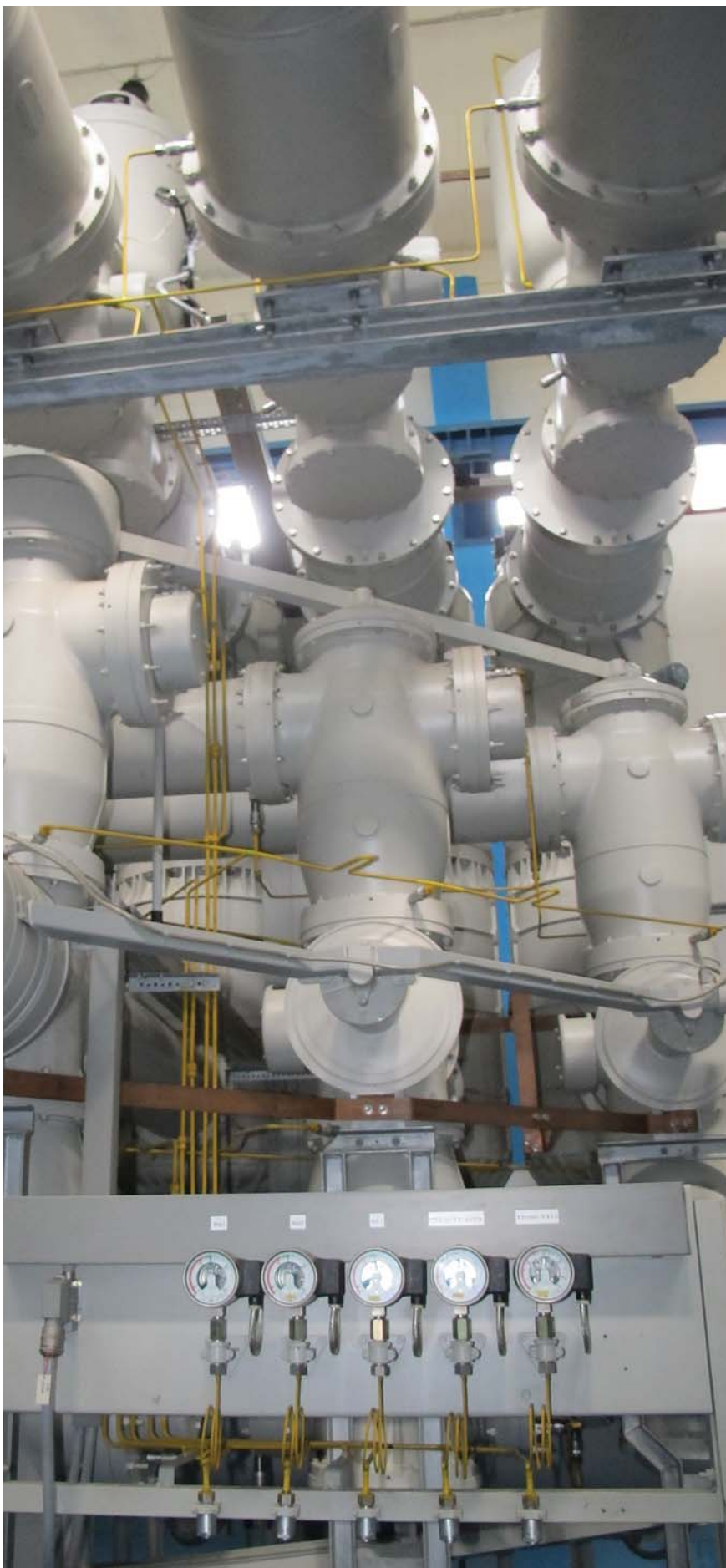
Část technologií zapouzdřené rozvodny
