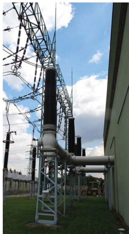
Vyvedení ze zapouzdřené rozvodny
