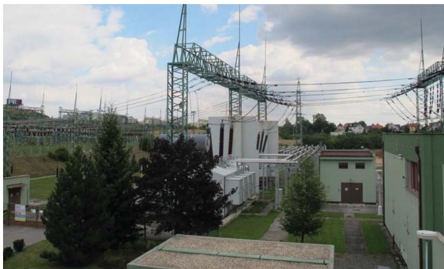
Pohled na stanoviště transformátorů
