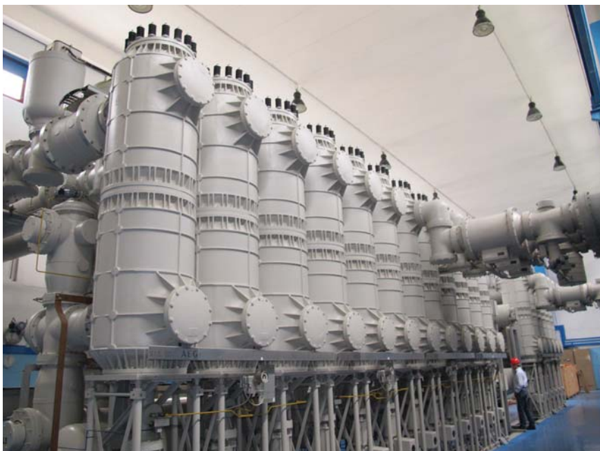
Pohled na zapouzdřená pole rozvodny Chodov
