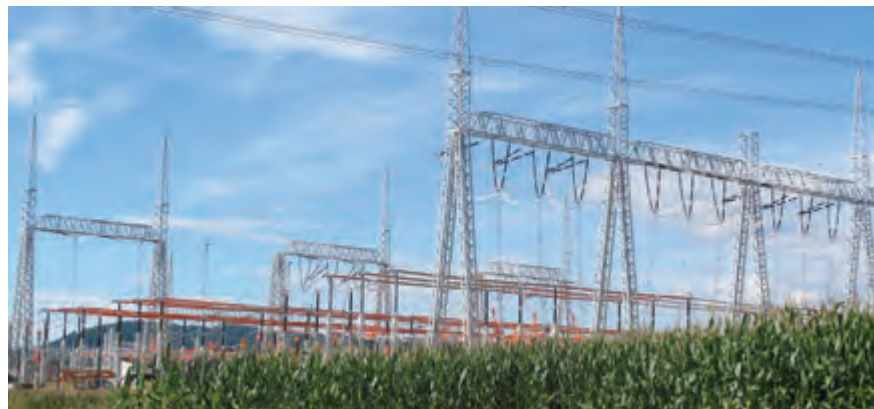
Transformovna zahájí provoz v prosinci 2011
