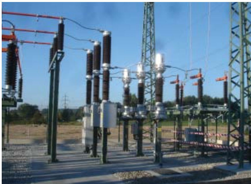
Rozvodna 110 kV uvedená do provozu v září 2010
