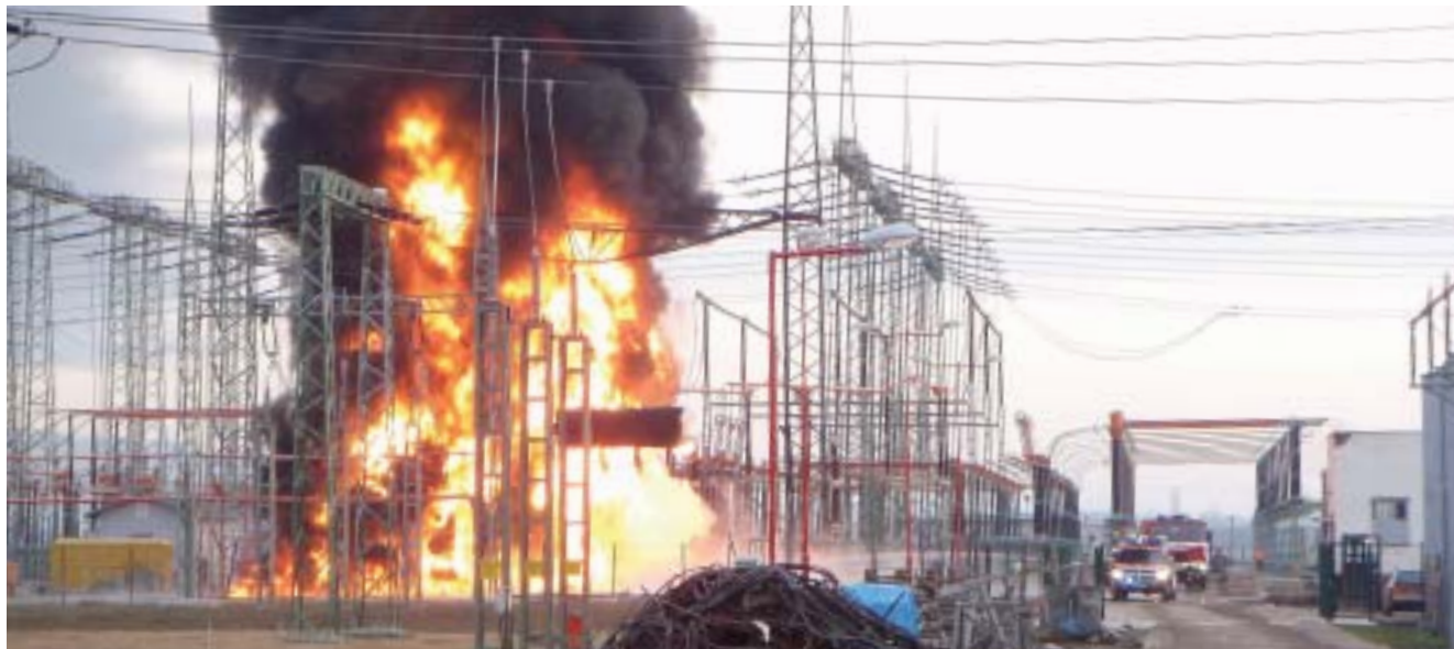
Požár transformátoru na rozvodně Výškov v roce 2009
