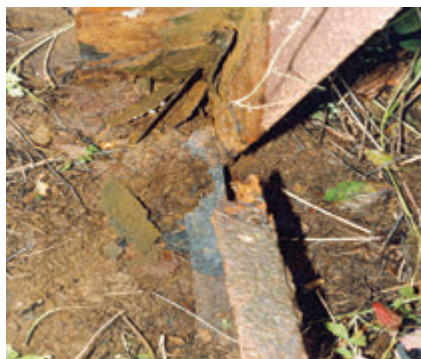
Rohový uholník votknutý v betónovom základe s odrodovanou diagonálou v blízkosti základu
