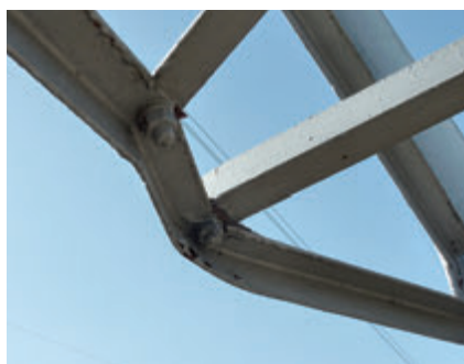
Detail plastickej deformácie výstužného križa v horizontálnej rovine
