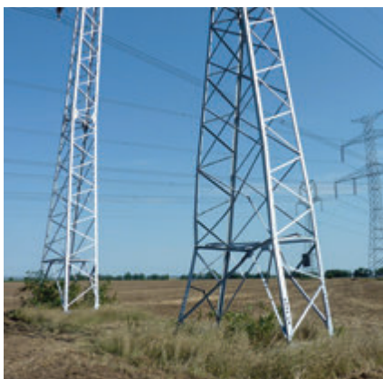
Portálový 400 kV stožiar, ťažký trojvázok, poškodený nárazom poľnohospodárskej techniky, imperfekcia rohového uholníka, diagonál, významná strata stability
