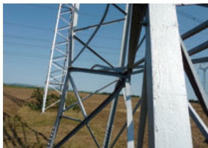
Iný príklad, kompletne zdeformovaný výstužný uzol v celom priereze drieku portálového stožiaru
