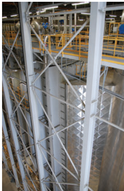
Pohled na výstupní spalínovod kotle vstup do komína
