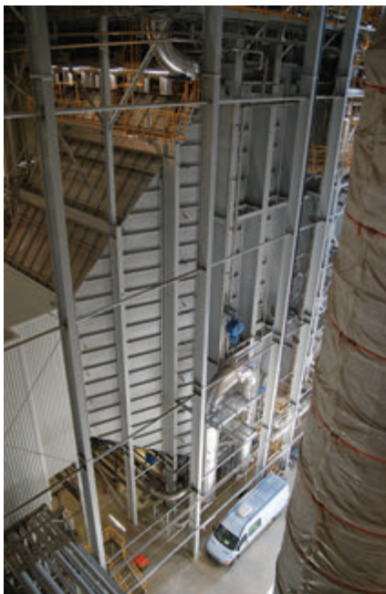
Pohled na vstupní spalínovod kotle ze strany spalovací turbíny. Dole stojí měřicí vůz BBS CZ v době garančních zkoušek
