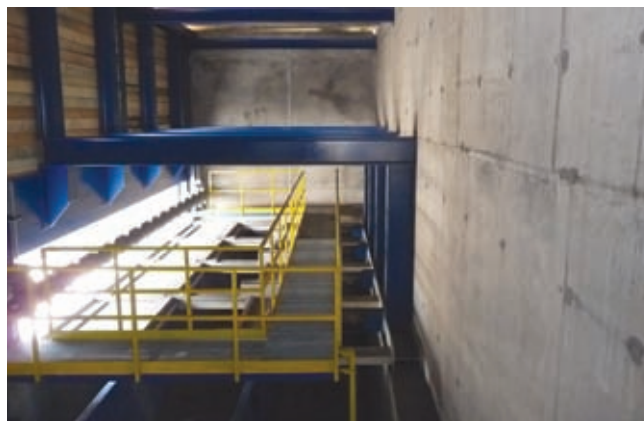
Strojovňa, pohľad na klzné podlahy
