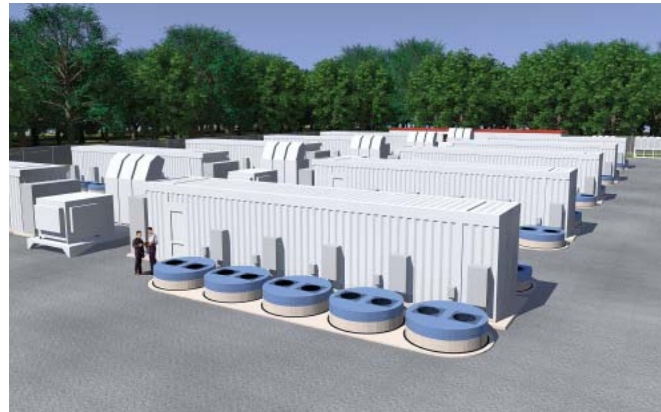
Instalace setrvačniců pro poskytování podpůrných služeb: setrvačnicí o výkonu 100 kW/ks (zapuštěné do země), řídicí elektronika (jeden kontejner na 10 setrvačniců) a trafostanice. (Zdroj: www.beaconpower.com)
