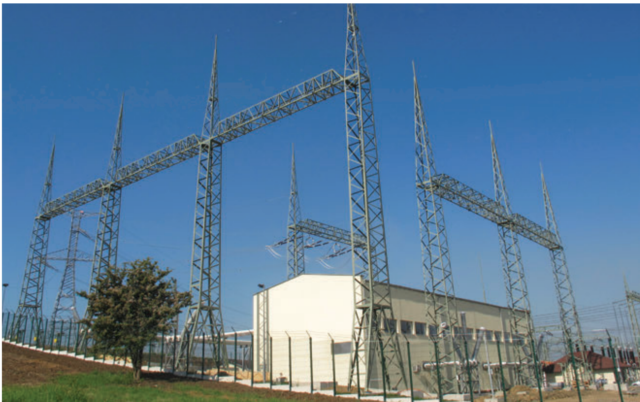
Celkový pohled na budovu zapouzdřené rozvodny
