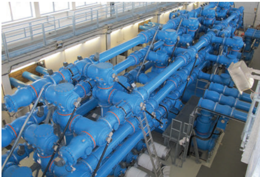
Zapouzdřené rozvodné technici říkají „pivo“
