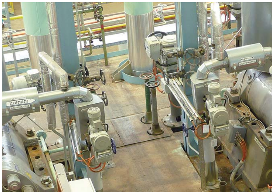
Blok A Elektrárny Tušimice II – strojovna
