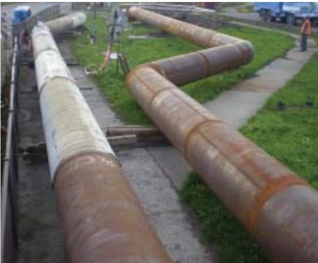
Přivaděče potrubí (OB51)
