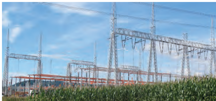
Transformovna zahájí provoz v prosinci 2011
