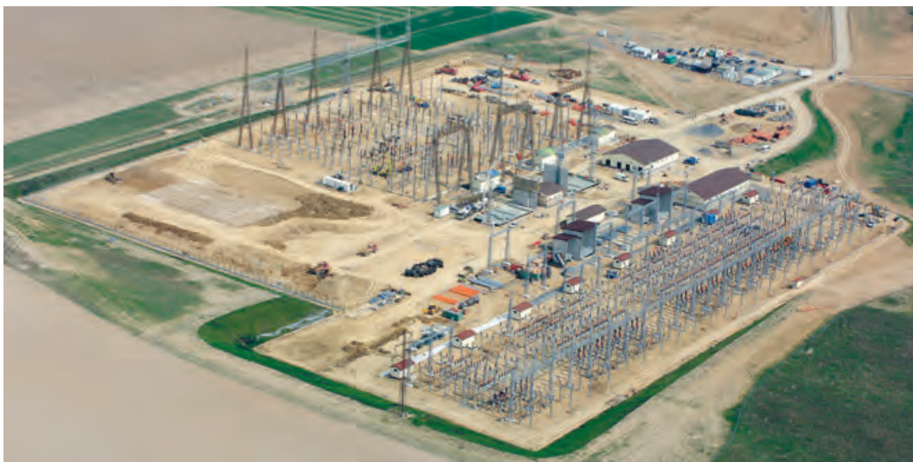
Cellkový pohled na transformovnu v Kletné z „ptačí“ perspektivy
