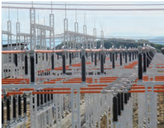
Pohled na zhášecí tlumivky
