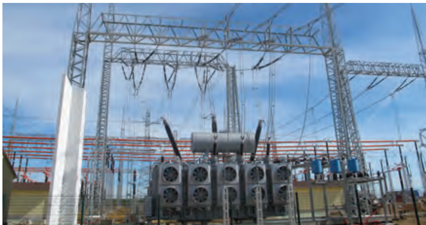
Pohled na zařízení transformace 400 kV transformovny Kletné
