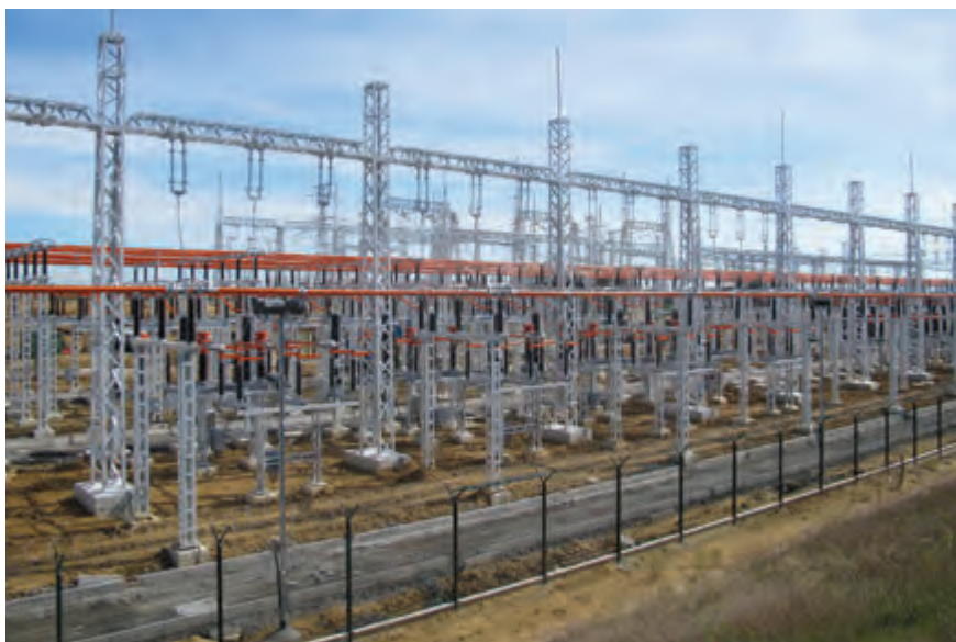
Pohled na transformovnu Kletné – část 110 kV
