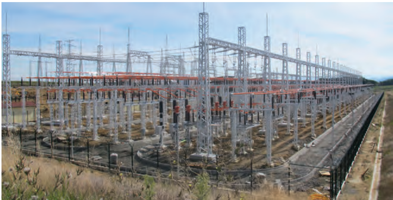
Pohled na transformovnu Kletné
