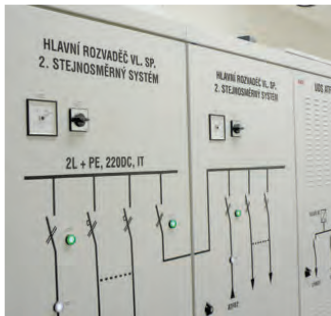
Hlavní rozvaděč vlastní spotřeby stejnosměrné 2. systém
