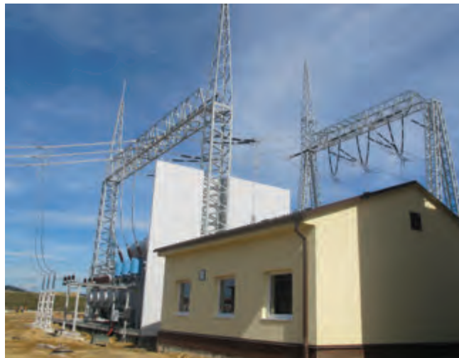
Jedna z budov v areálu transformovny
