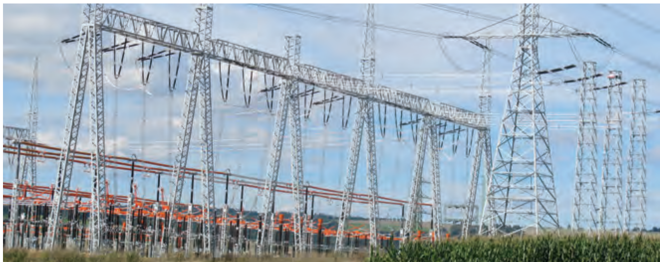
Pohled na transformovnu Kletné – část 400 kV
