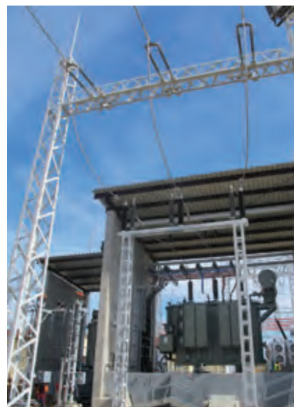
Stanoviště transformátoru a tlumivky 110/23 kV
