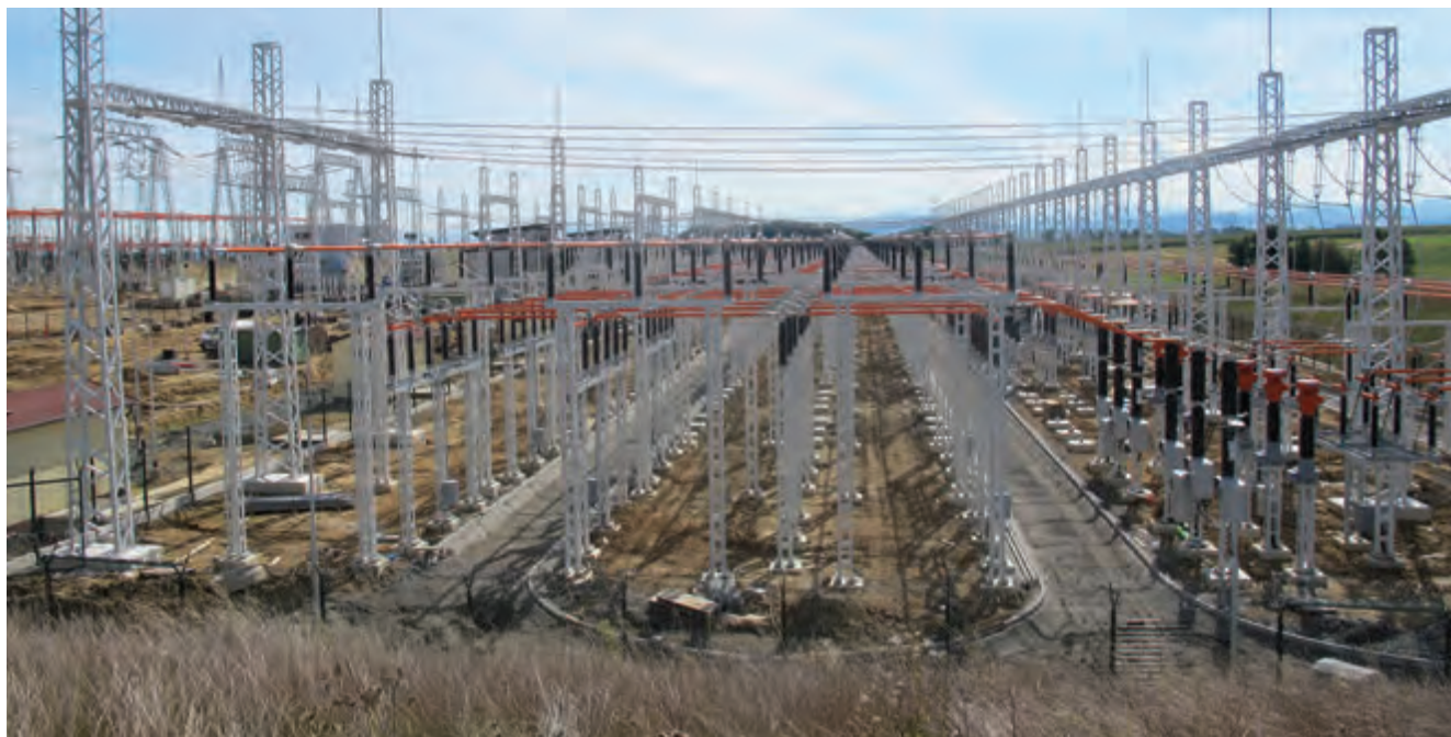
Pohled na rozvodnu Kletné - část 110/22 kV
