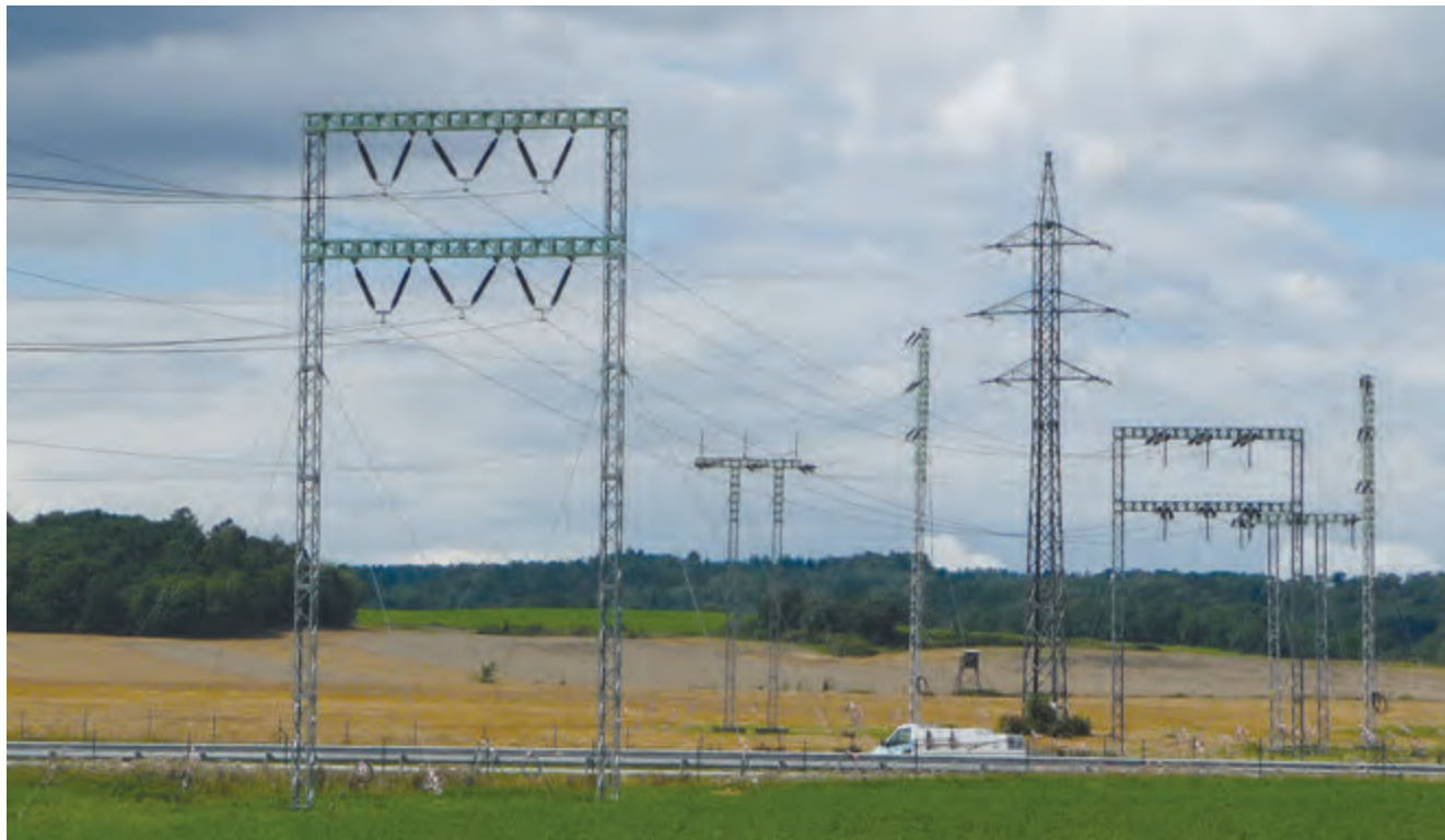
Vývodové linky, bypass, odbočka Odry - Vítkov
