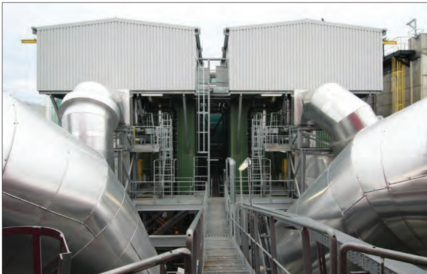
Napojení spalínovodů na textilní filtry
