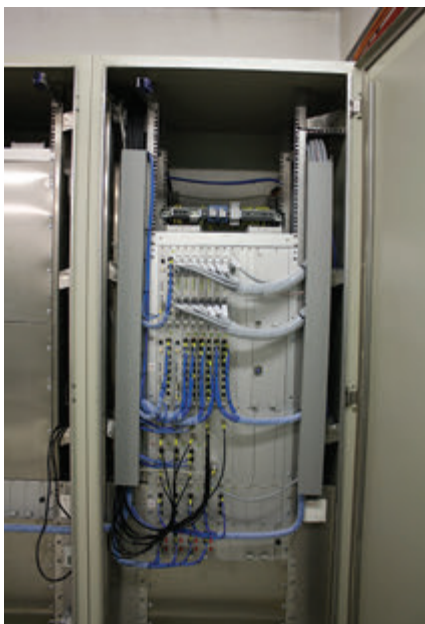
Obr. 5 – Pohled do skříně s měřicími ústředními monitorovacího systému transformátorů MOSAD® MST
