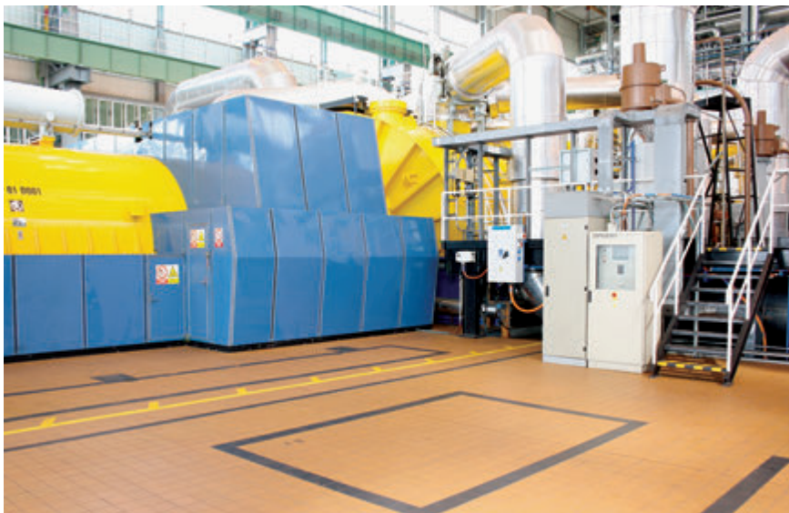
Obr. 6 – Pohled na skříně diagnostického systému MOSAD® IRIS umístěnou vedle generátoru 1 000 MW
