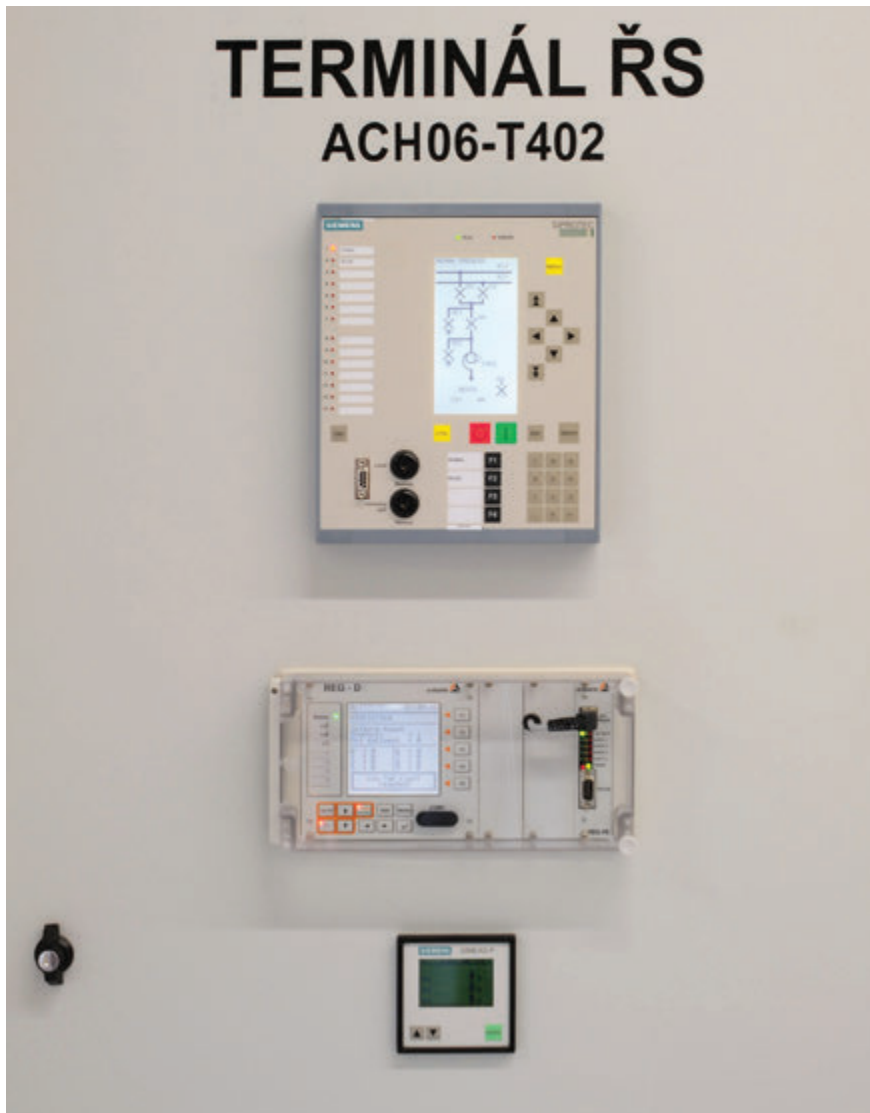
Zařízení řídicího systému pro pole transformátoru - terminál 6MD66, regulátor transformátoru a měřící převodník
