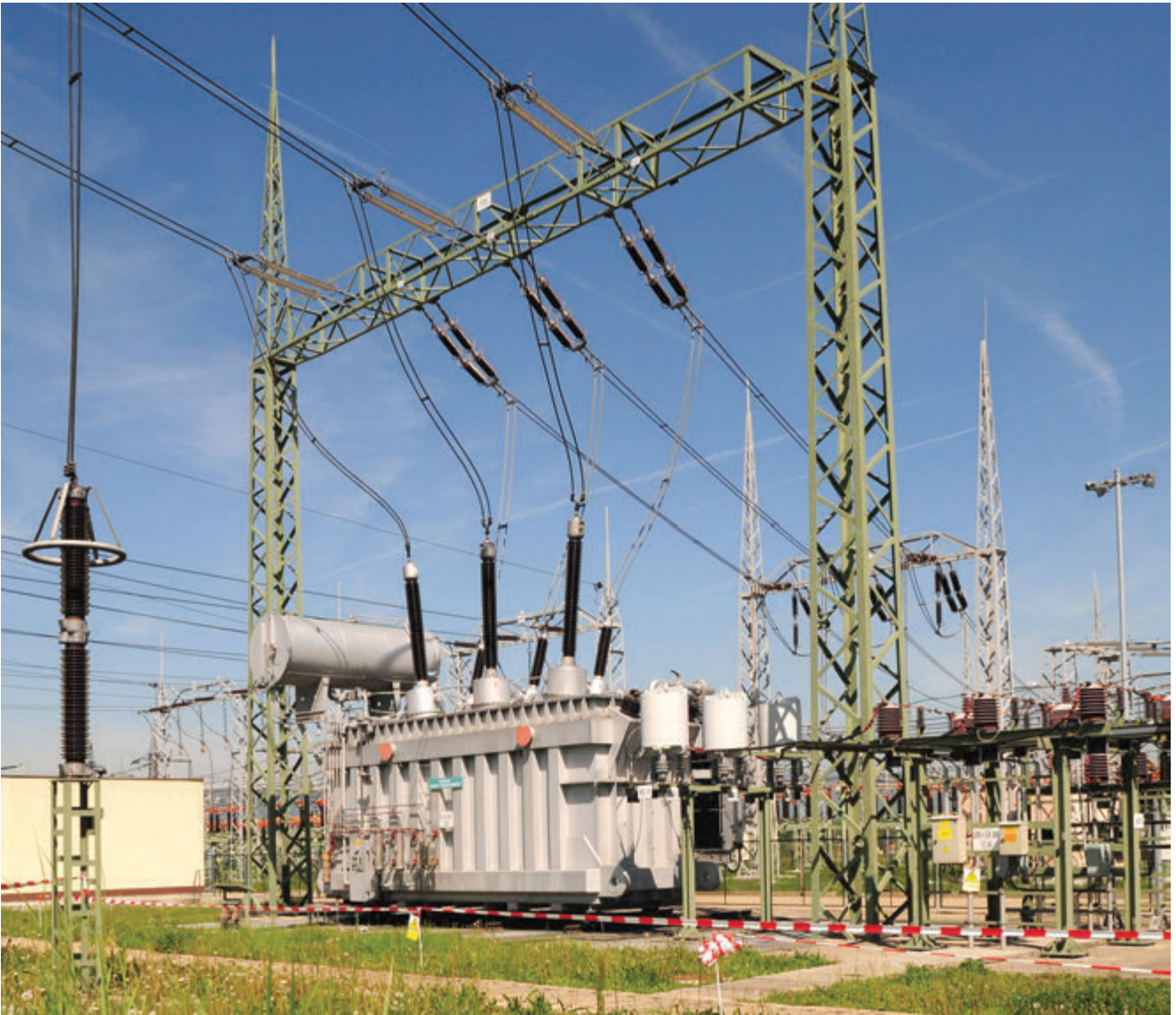
Pohled do rozvodny 220 kV, transformátor 220/110 kV
