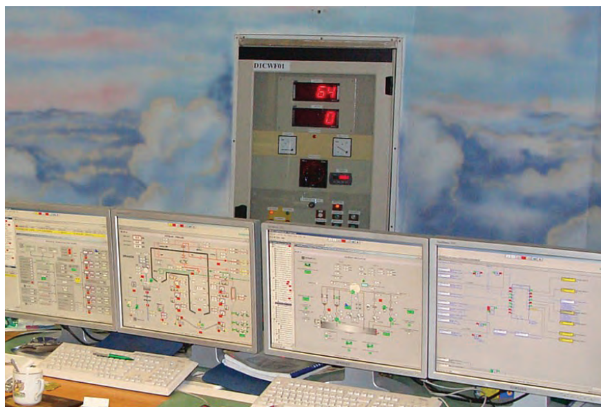
Operátorská pracoviště bloku D, v pozadí nouzový ovládací panel
