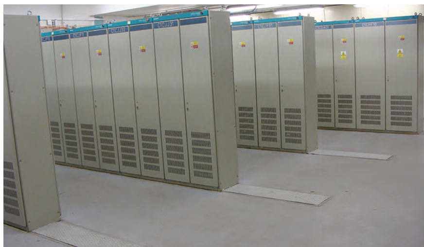
Ukázka aplikace rozváděče řídicího systému SPPA-T3000 na bloku C Elektrárny Tušimice II
