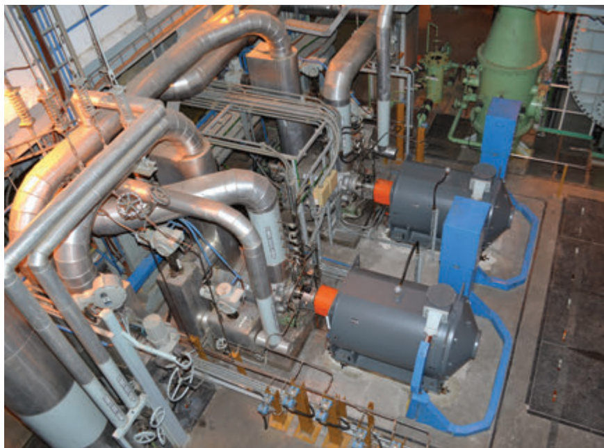
Poruchové napájecí stanice sekundárního okruhu
