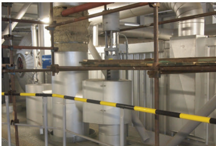
Potrubié k tlmíču hluku s poistnými ventilmi a kotlové teleso
