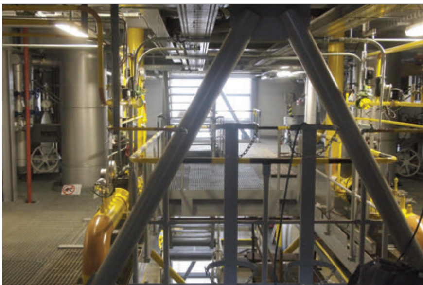
Potrubié rozvody zemného plynu na plošine +17,400 m
