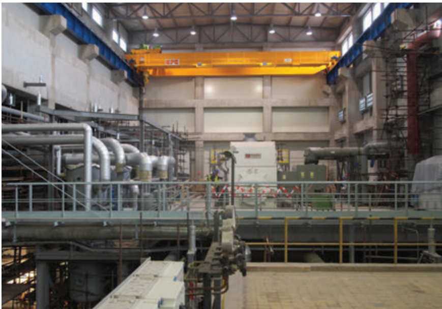
Pohľad do strojovne
