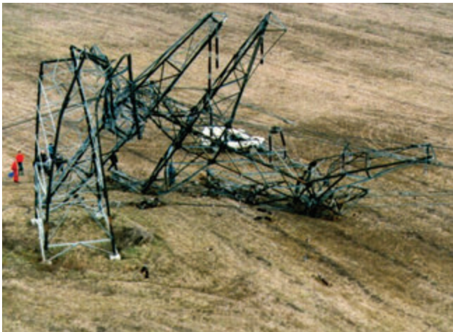
Napriek normám vyhovujúce stožiare, a to aj s dobrou údržbou, nevydržali v tomto prípade vplyv poryvového vetra
