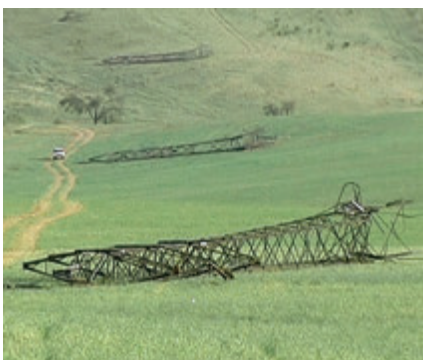
Dominovým efektom zrútené stožiare 2 × 110 kV vplyvom poryvového vetra
