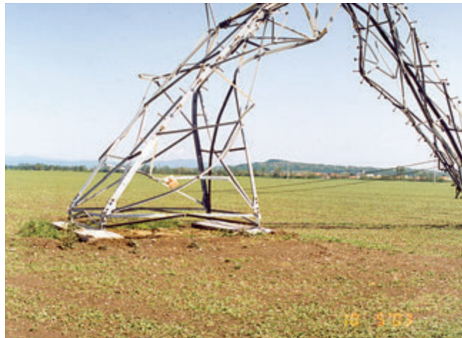
Kolaps stožiaru obvykle poškodí aj základový diel a vyžaduje prácnú sanáciu betónu
