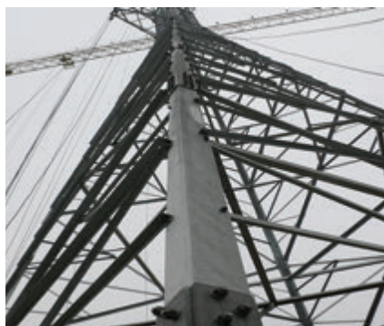
Rohový uholník ťažkého 400 kV stožiaru
