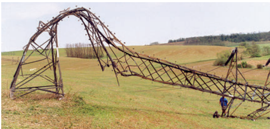
Kolaps priehradovej konštrukcie stožiaru s pretrhnutými okami v uholníkoch
