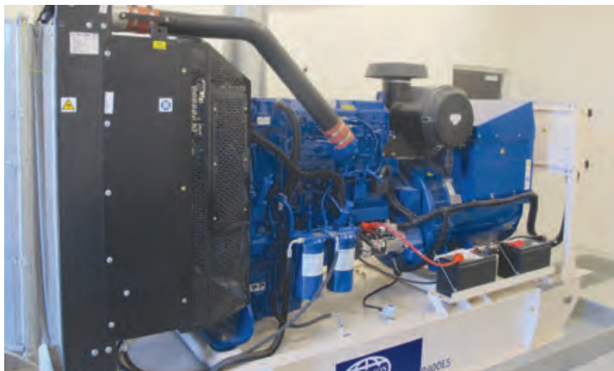
Pohled na dieselgenerátor FG Wilson
