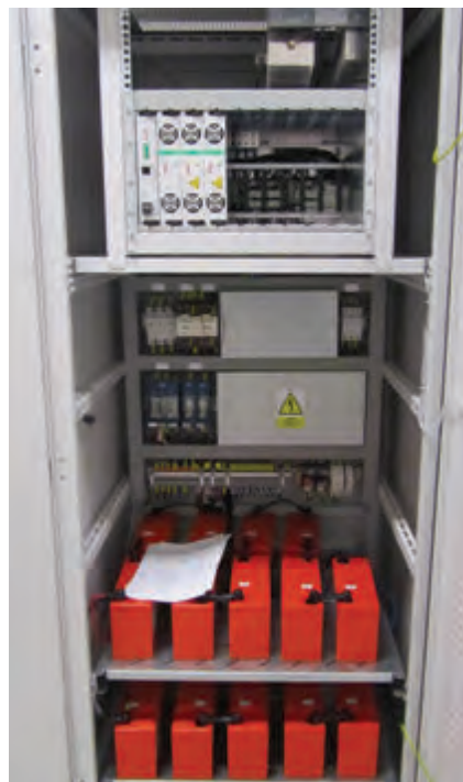
Pohled do útrobu modulárního spínaného usměrňovače Protect MIP
