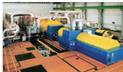
Strojovna jaderné elektrárny Temelín
