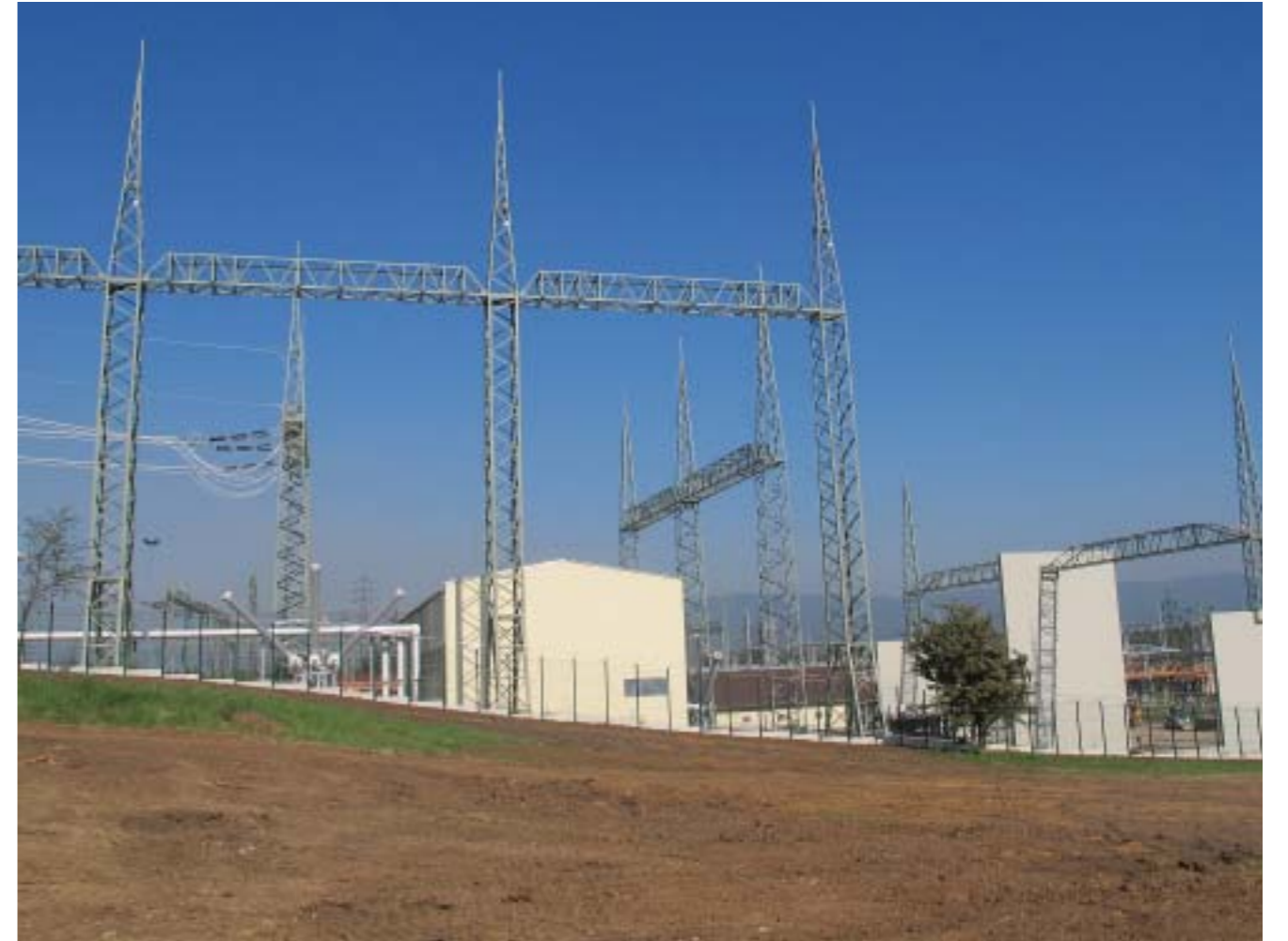
Celkový pohled na novou transformovnu
