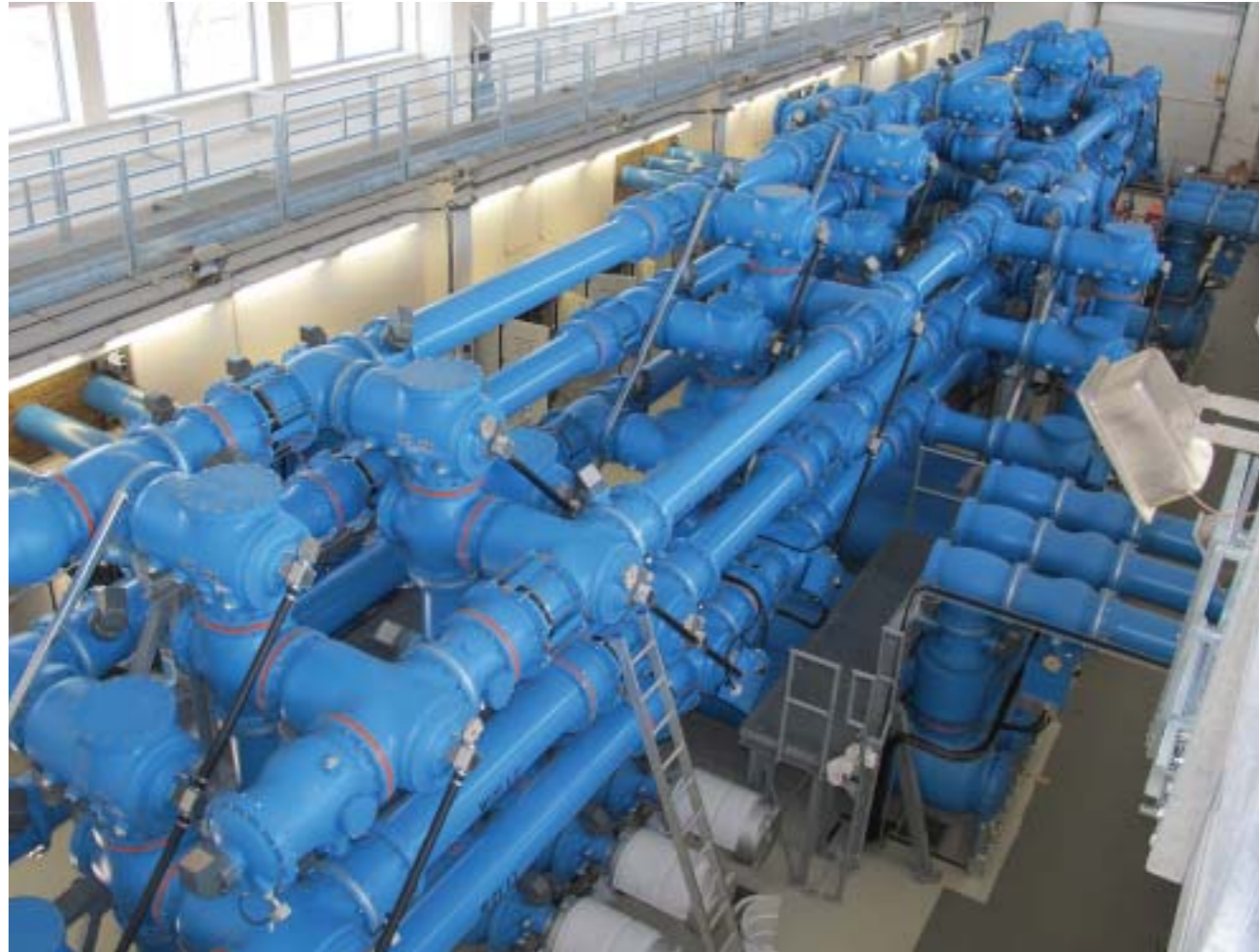
Zapouzdřená rozvodna v Chotějovicích
