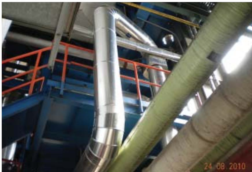
Proplétající se potrubí horkovodu
