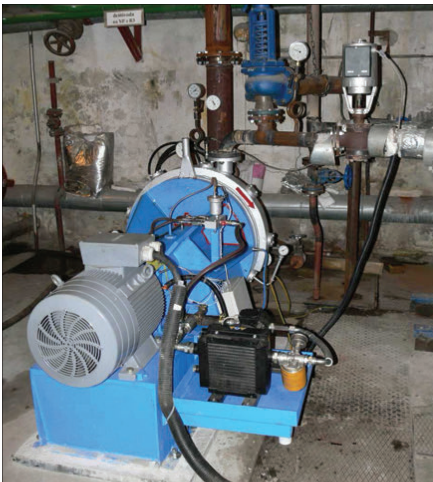
Obr. 7 – Turbína o výkonu 30 kW
