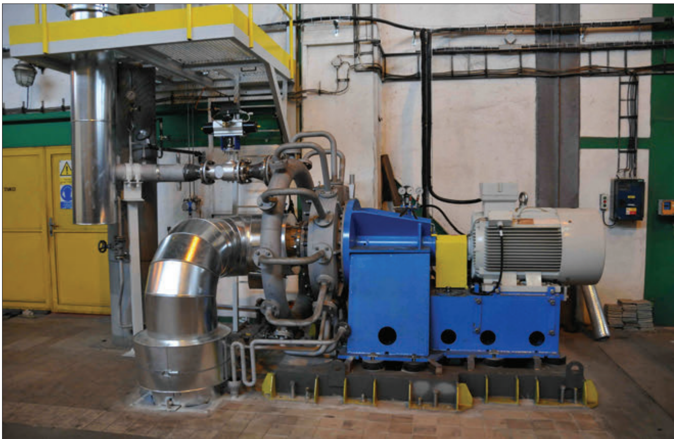
Obr. 6 – Turbogenerátor o projektovaném výkonu 110 kW
