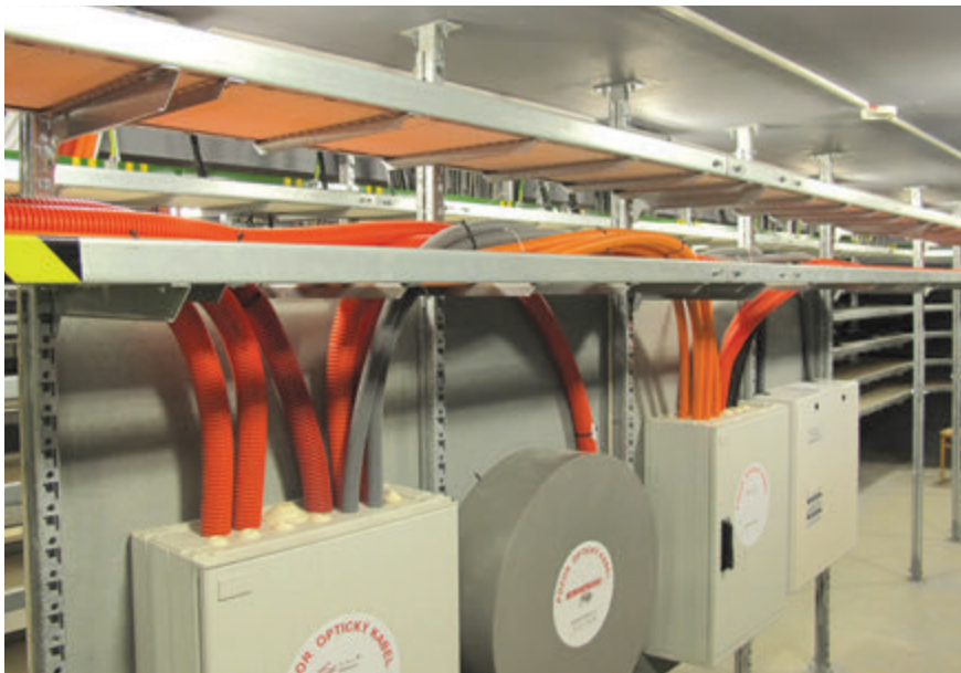
Kabelový prostor v suterénu
