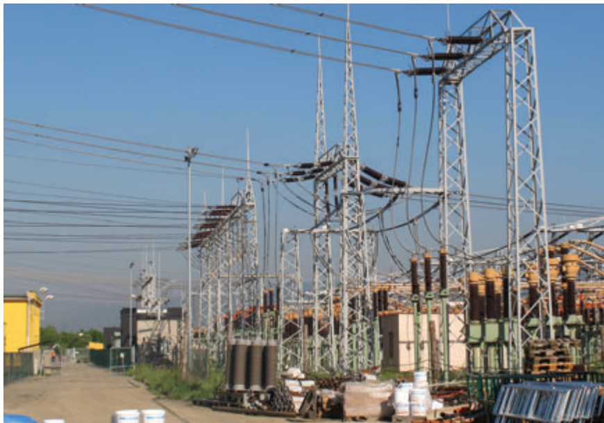
Propojení se stávajícím zařízením transformovny
