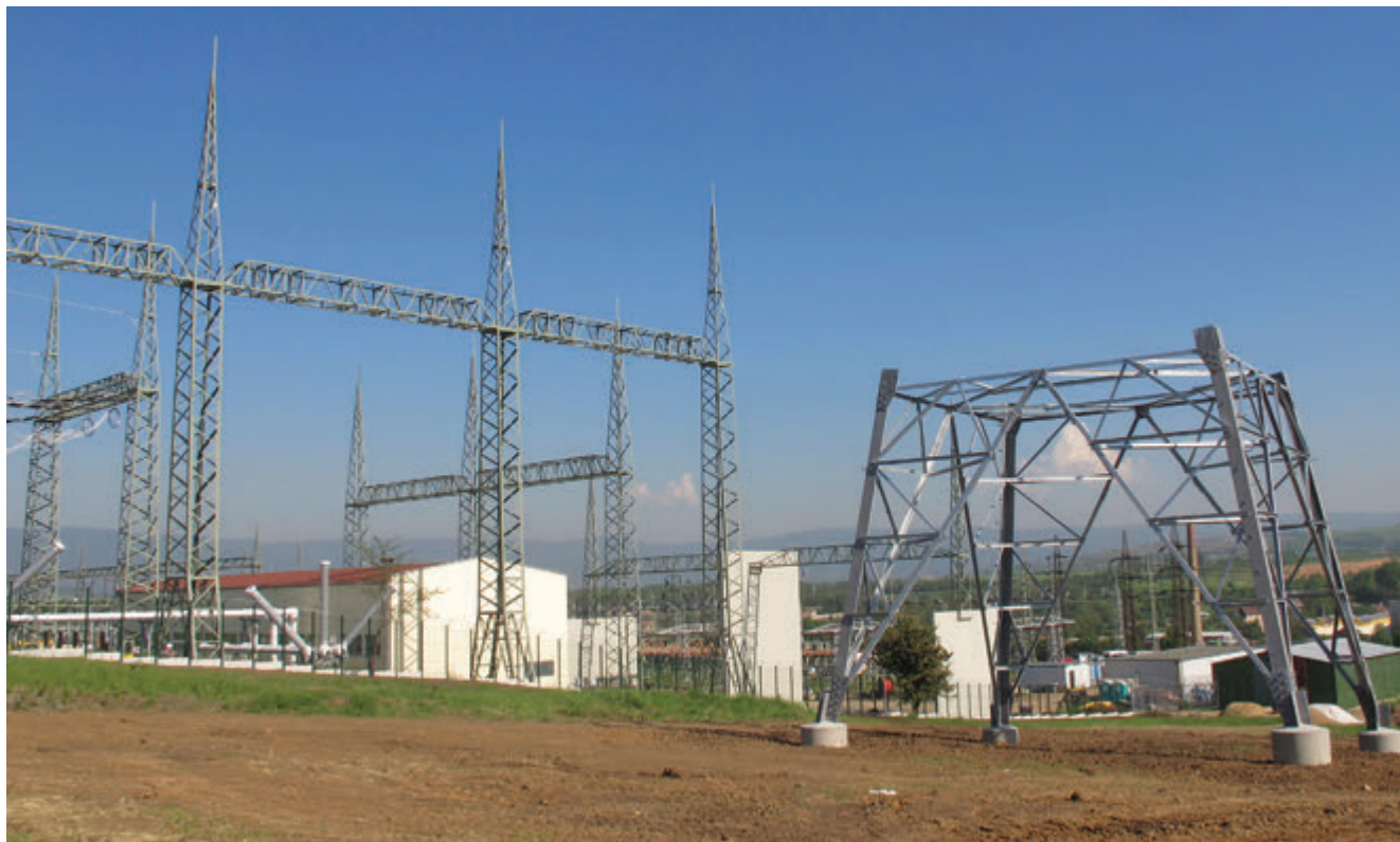
Celkový pohled na transformovnu
