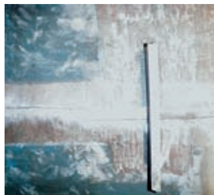
Obr. 3 – Obvodová trhlina a zajišťovací krátká žebra
